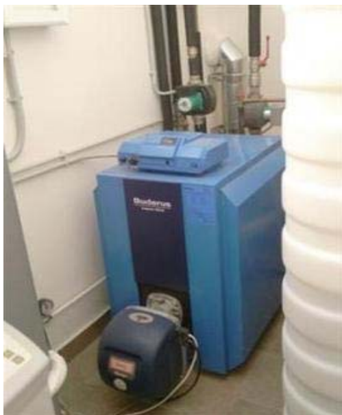
Σχήμα 5.16: Λέβητας φυσικού αερίου
