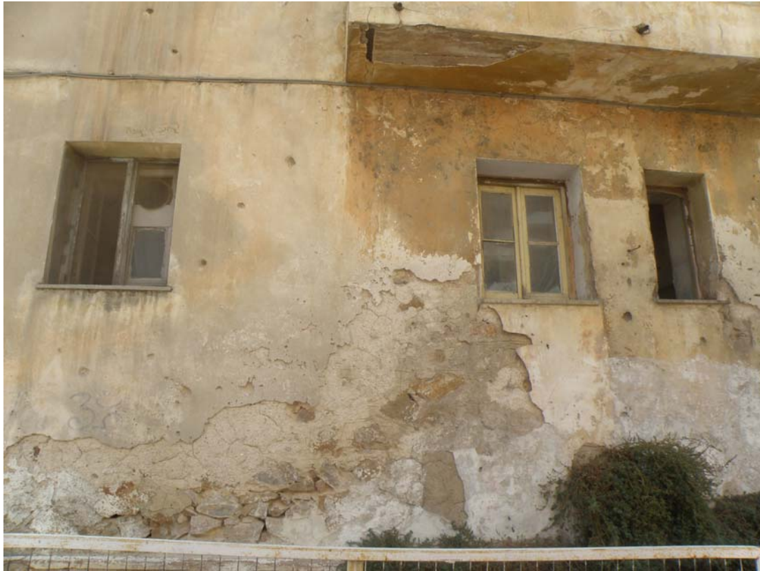
Σχήμα 4.6: Φθορές στο κτιριακό κέλυφος και στα κουφώματα
