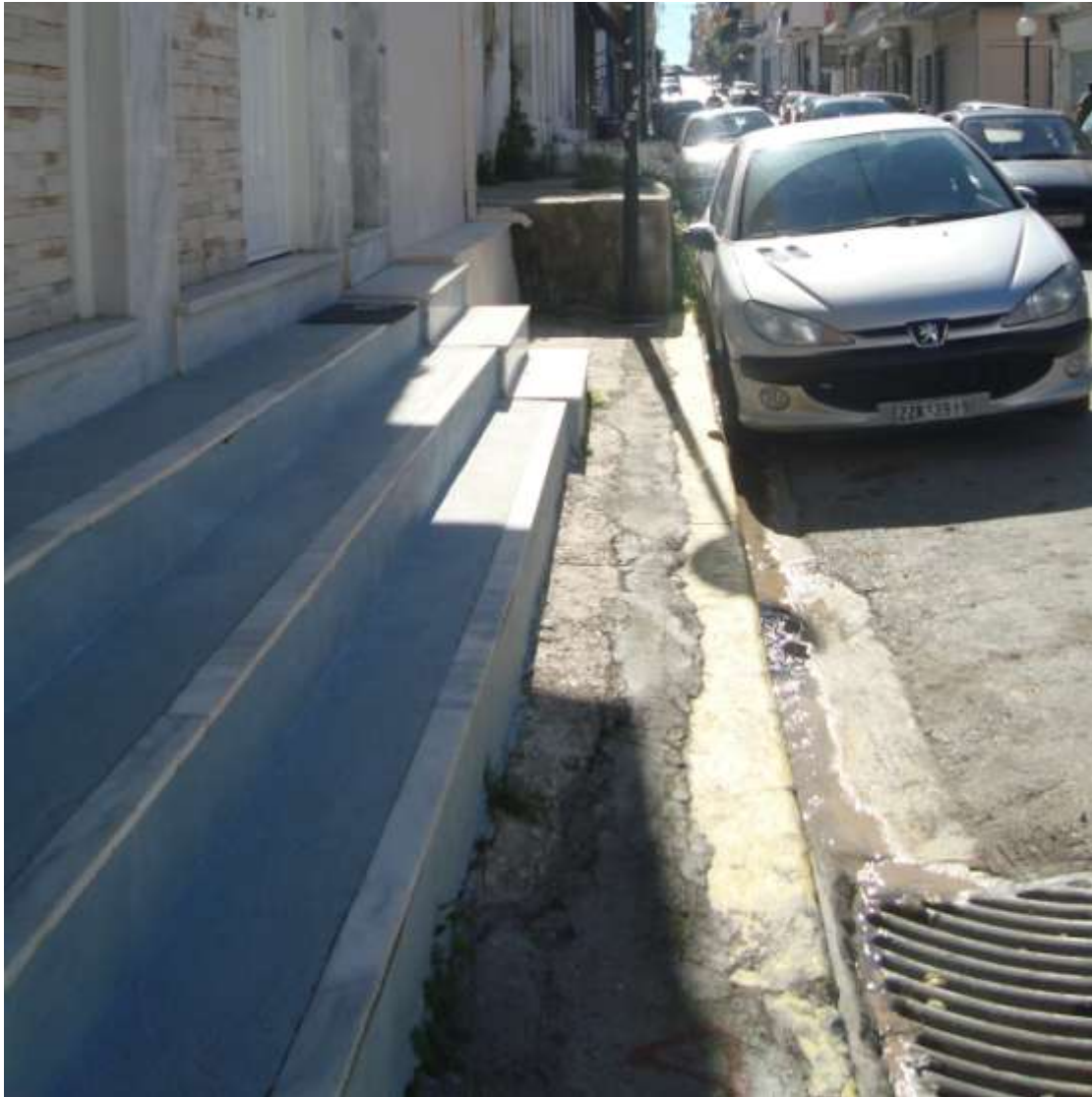
Εικόνα 57. Στη παρούσα φωτογραφία η επέμβαση του ιδιώτη εμποδίζει την διέλευση των πεζών απο το σημείο αυτό του πεζοδρομίου.
