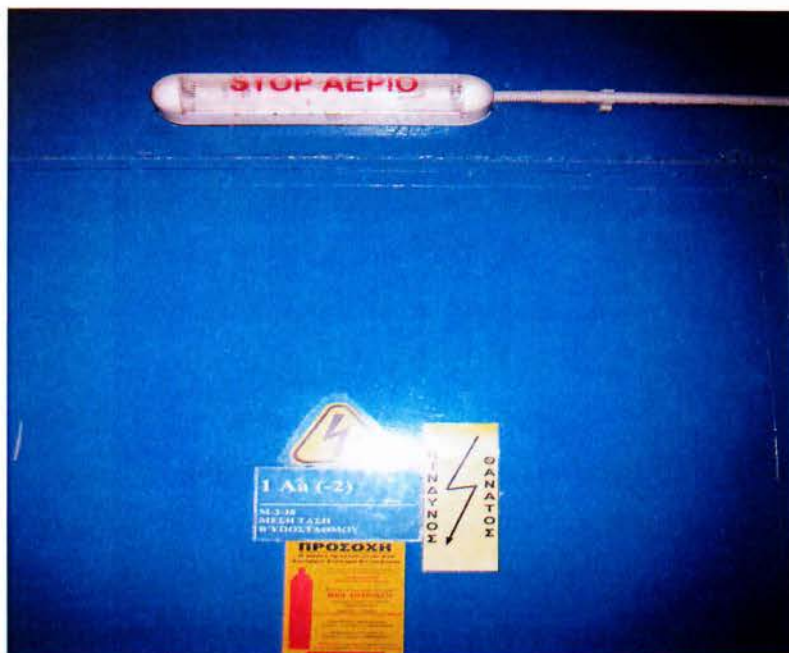
Πόρτα υποσταθμού μέσης τάσης
