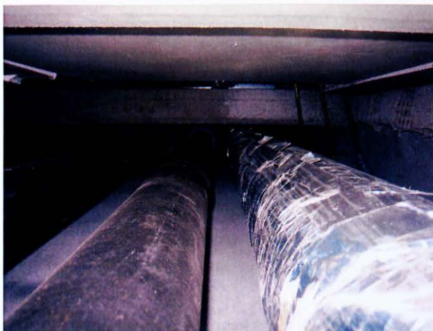
Κατακόρυφη όδευση μέσα στο μηχανολογικό κενό
