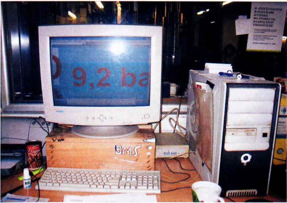
Κέντρο ελέγχου BMS
