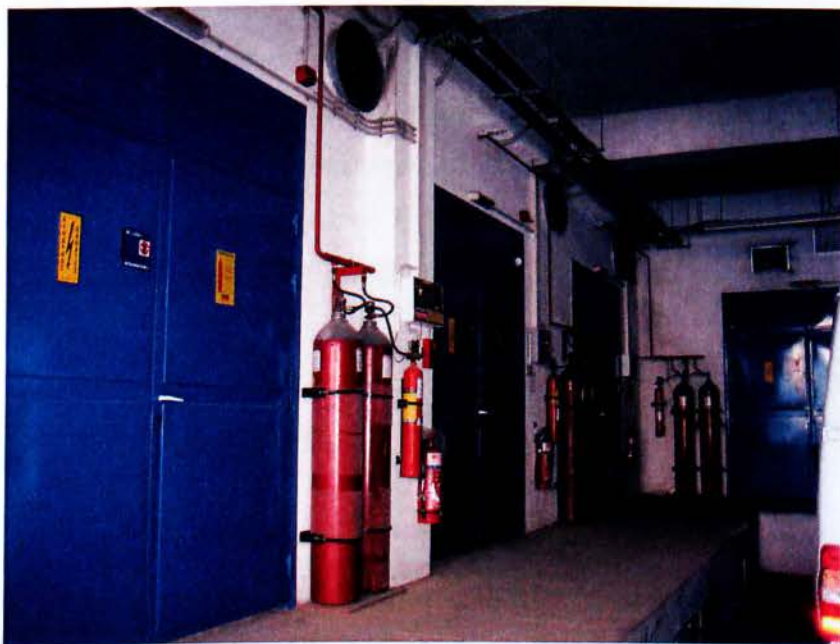
Πυρόσβεση έξω από υποσταθμό μέσης τάσης
