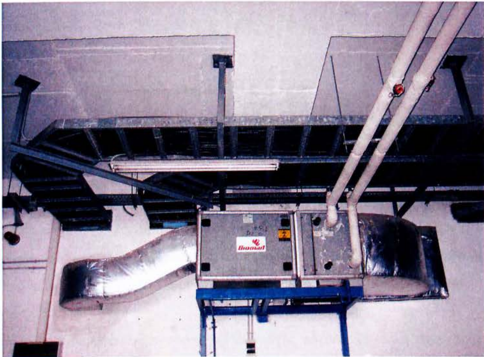
Κλιματιστική μονάδα οροφής
