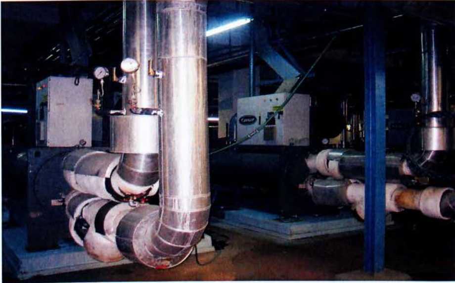
Κεντρική μονάδα κλιματισμού στο Λ/Σ
