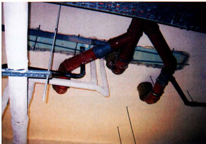
Κατακόρυφη όδευση σωληνώσεων κλιματισμού
