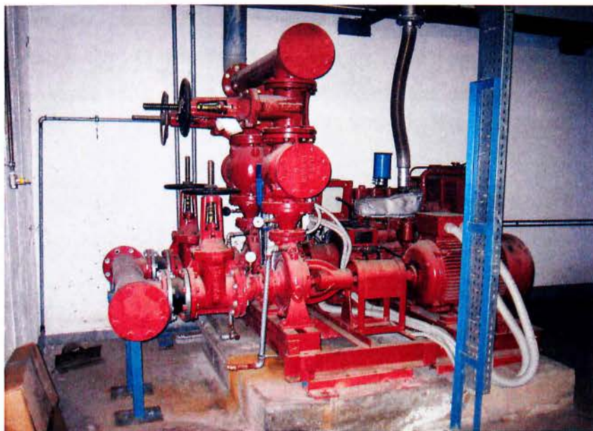
Αντλίες δικτύου πυρόσβεσης
