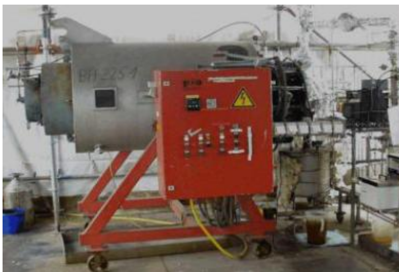
Εικόνα 4.4 Εξοπλισμός επεξεργασίας ελαστικού με τη μέθοδο της πυρόλυσης
