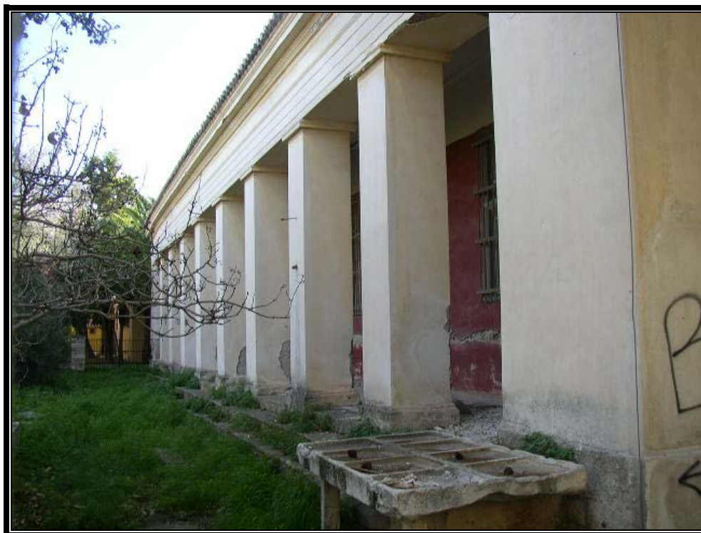
Εικόνα 19. Εμφανής είναι οι φθορές στο Εϋνάρδειον Διδασκαλείον
