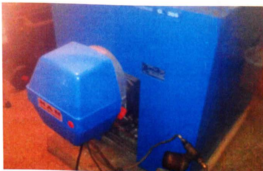
Εικόνα 18 Φωτογραφίες από το λεβητοστάσιο
