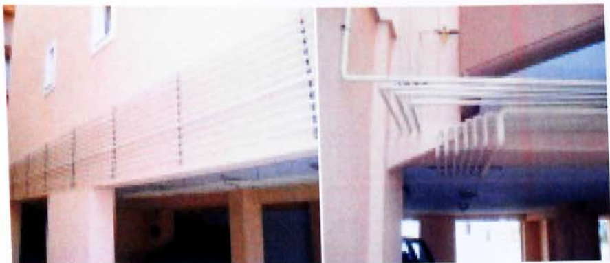
Εικόνα 20 Σωλήνωση φυσικού αερίου με ράγα στήριξης, υπόγεια γραμμή φυσικού αερίου,
