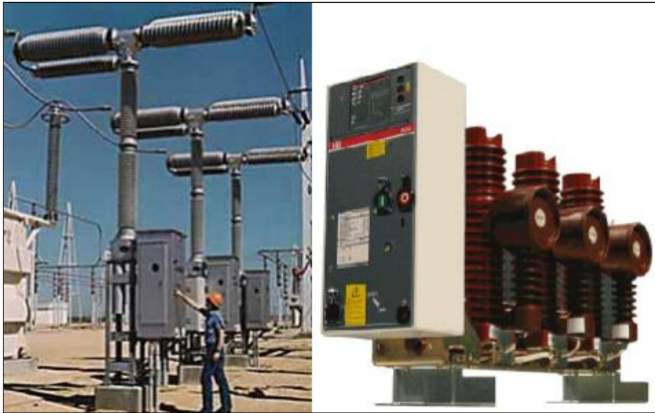
Εικόνα 28 : Διακόπτες ισχύος υποσταθμών διανομής ηλεκτρικού ρεύματος / Εξωτερική εμφάνιση διακόπτη ισχύος σε βιομηχανική μονάδα
