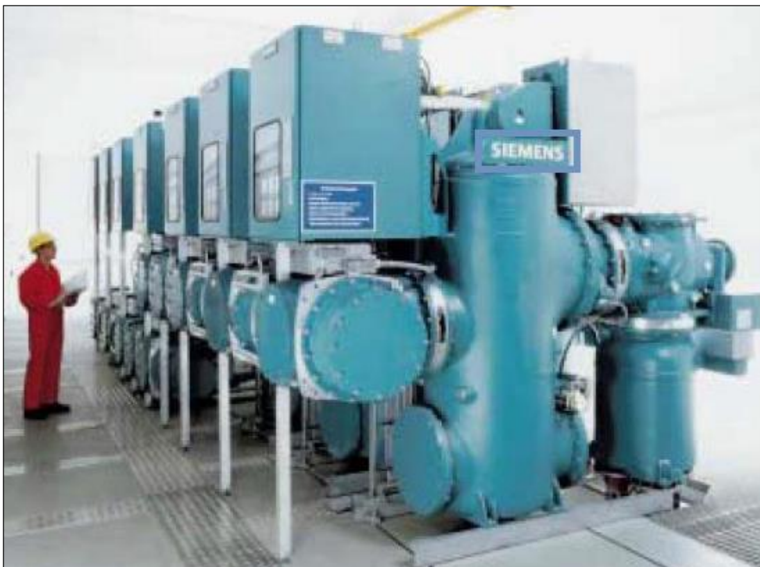
Εικόνα 29 Υποσταθμός με διακόπτες GIS με αέριο SF 6 145 kV σε στεγασμένο χώρο
