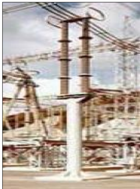
Εικόνα 27 : Μονωτήρας τύπου post σε Υ/Σ
