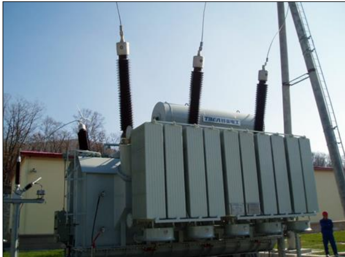
Εικόνα 24 : Μονωτήρες διασύνδεσης μετασχηματιστή
