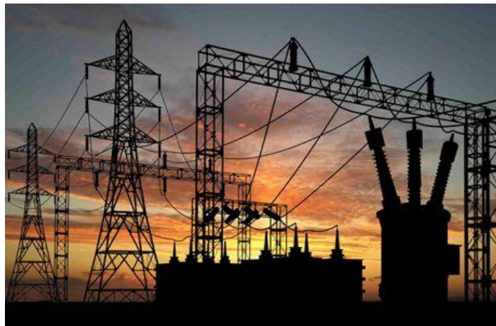
Εικόνα 4 : Υποσταθμός δικτύου μεταφοράς
