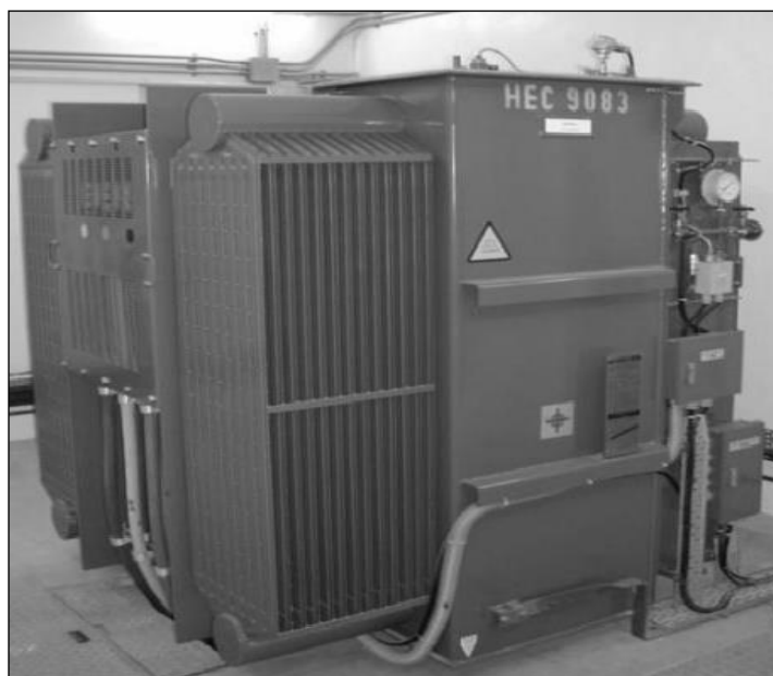
Εικόνα 31: Μετασχηματιστής ισχύος 1500 kVA με μόνωση SF 6 22kV / 390 V
