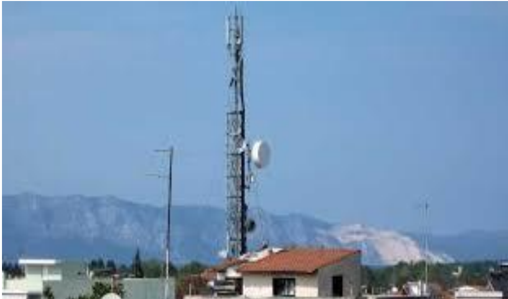
Εικόνα1.2: Παράδειγμα τοποθέτησης κεραίας κινητής τηλεφωνίας σε κατοικημένη περιοχή.
