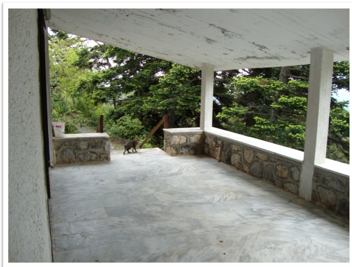
Εικόνα 40: Αποκόλληση του επιχρίσματος της οροφής του εξώστη
