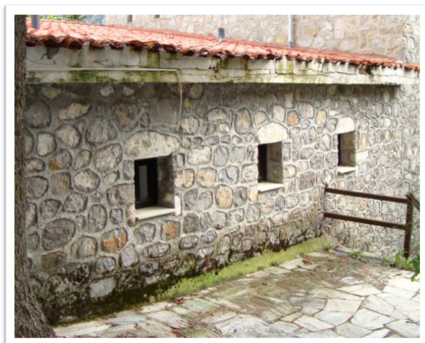
Εικόνα 41: Ρωγμές στην πλάκα
