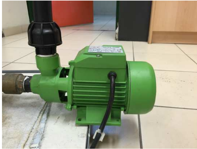
Εικόνα 1: Αντλία (Water Pump) με Α.Τ.Κ. που τροφοδοτεί το την δεξαμενή (δοχείο)
