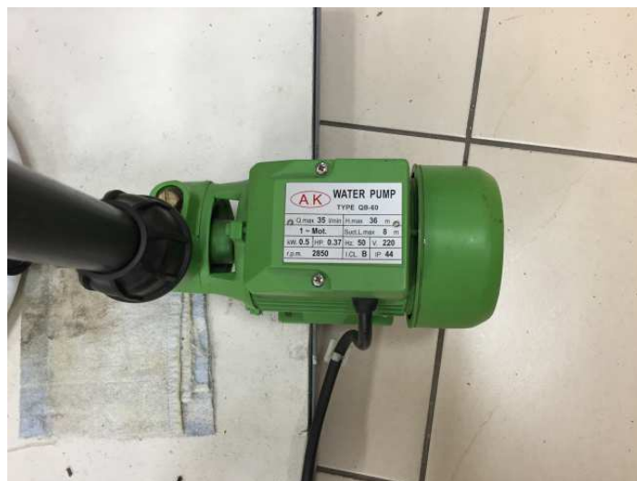
Εικόνα 2: Αντλία (Water Pump) με Α.Τ.Κ. που τροφοδοτεί το την δεξαμενή (δοχείο)
