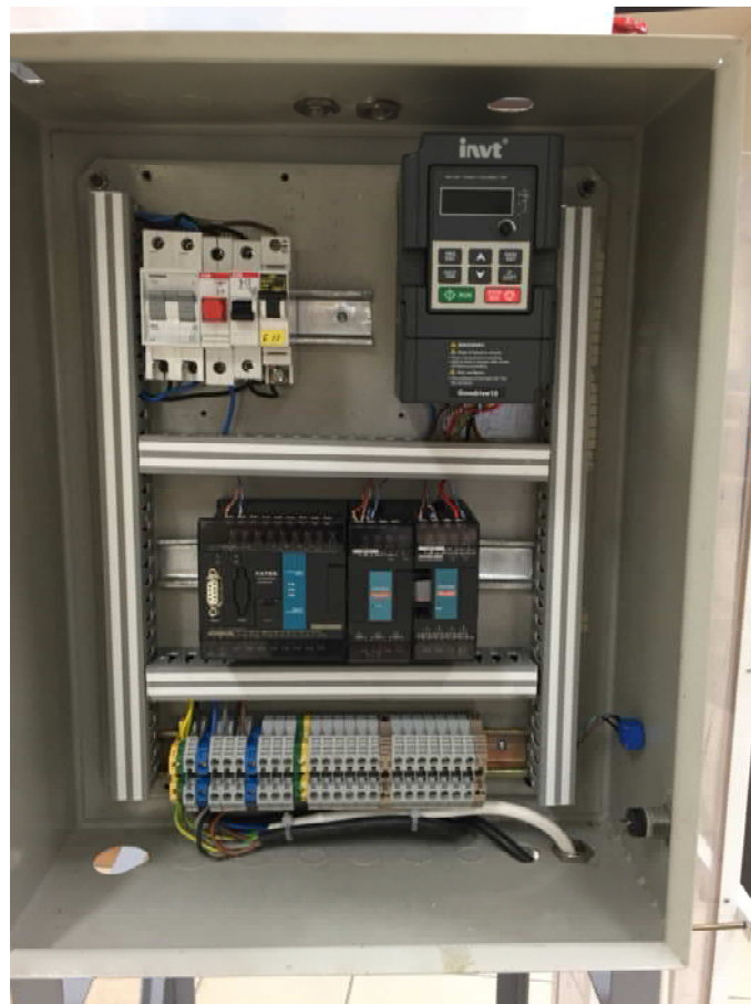
Εικόνα 6: Κεντρικός πίνακας αυτοματισμού για τον πλήρη έλεγχο της κατασκευής, που περιλαμβάνει ασφάλειες, γενικό διακόπτη, PLC και INVERTER.
