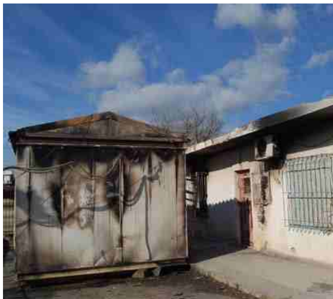
Εικόνα 3.4 (α,β): Διάρρηξη και πυρπόληση της αποθήκης σκαπτικών εργαλείων του εργοταξίου του Δήμου Ζεφυρίου, που στεγάζεται στο χώρο του γηπέδου (Ο.Τ. 69)
