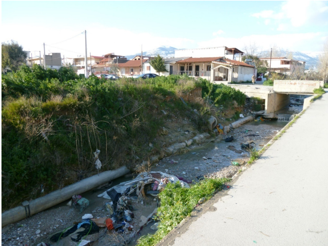
Εικόνα 5.3: Απουσία κιγκλιδώματος, σκουπίδια, αγωγοί, παραρεμάτια δόμηση
