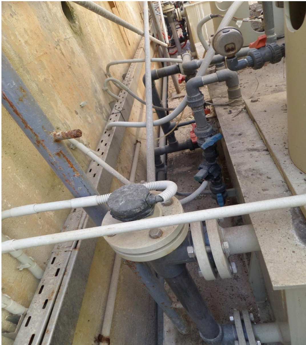
Εικόνα 43 Φλοτέρ δεξαμενή διαλύματος. Είναι τοποθετημένο μέσα σε σωλήνα που συνδέεται με την δεξαμενή.
