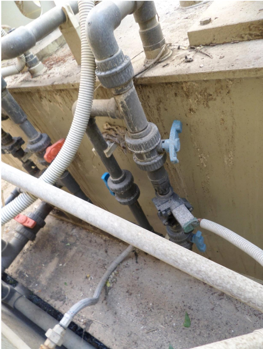
Εικόνα 45 Ηλεκτροβάννα που συνδέεται με το δίκτυο ύδρευσης κ συμπληρώνει την δεξαμενή όταν χρειαστεί.
