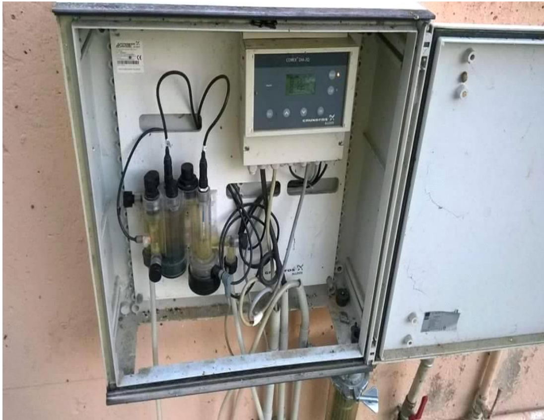
Εικόνα 30 Σύστημα ελέγχου των χλωριωτών και των θειωτών
