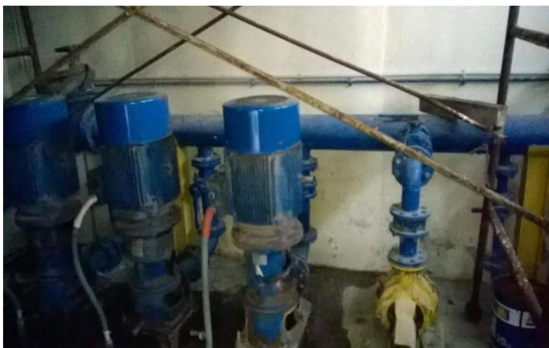
Εικόνα 35 Αντλίες βιομηχανικού νερού
