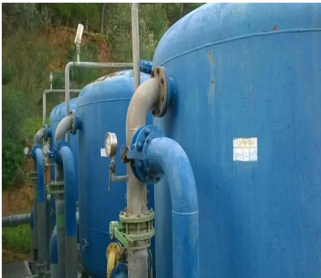
Εικόνα 34 Φίλτρα βιομηχανικού νερού
