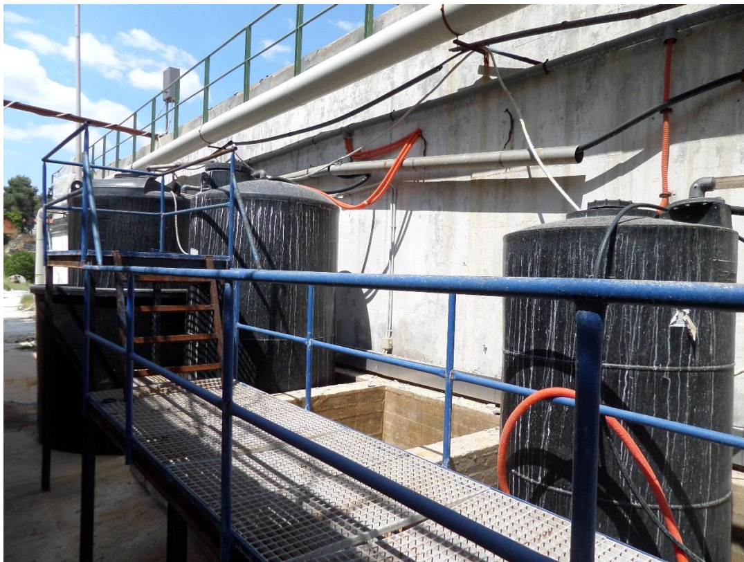
Εικόνα 39 Τρεις δεξαμενές των χημικών χλωρίου, οξέος και σόδας
