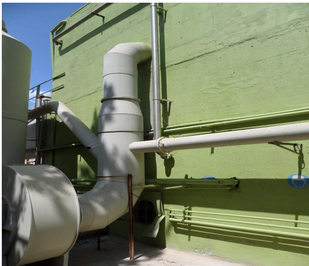
Εικόνα 37 Κτίριο προ επεξεργασίας κ σωληνώσεις εξαερισμού
