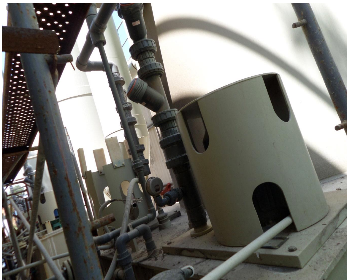
Εικόνα 46 Κυλινδρικό κουτί όπου βρίσκεται μέσα η αντλία για προστασία. Η κάθε βαρέλα έχει δύο αντλίες .
