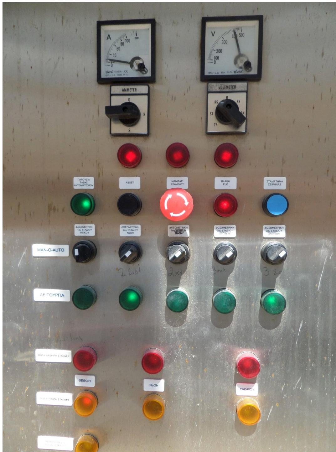
Εικόνα 50 Ενδείξεις λειτουργίας πίνακα
