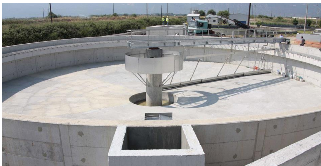
Εικόνα 18 Άδεια δεξαμενή καθίζησης
