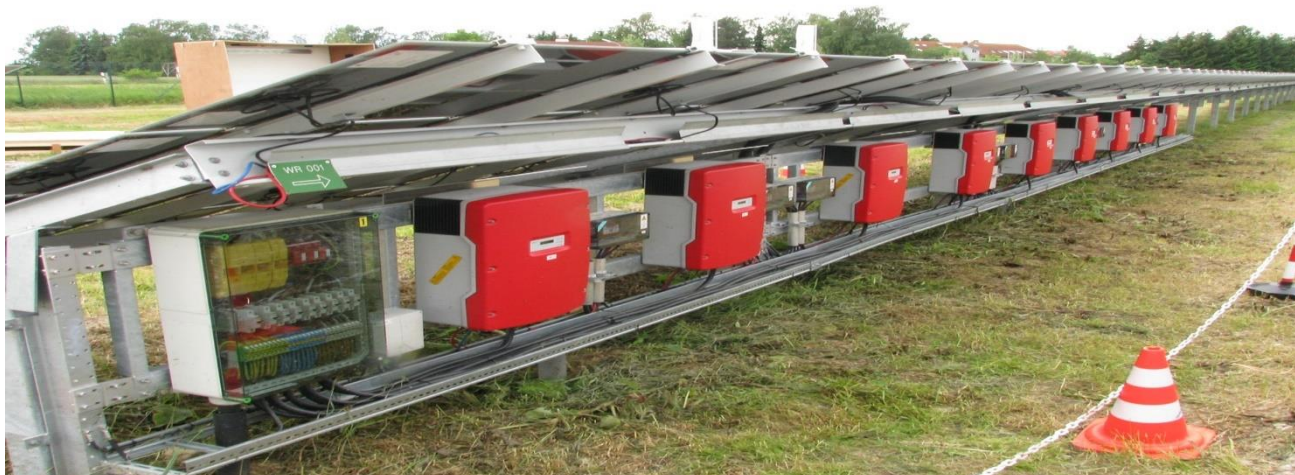
Εικόνα 22 "Αντιστροφείς σε φωτοβολταϊκή εγκατάσταση" ( google.gr/invertersoutlook .)
