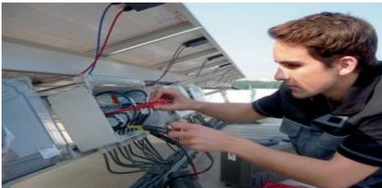
Εικόνα 24 "Καλωδίωση και Ασφάλειες σε φωτοβολταϊκά πάνελ" ( google.gr/kalodiosispanels )
