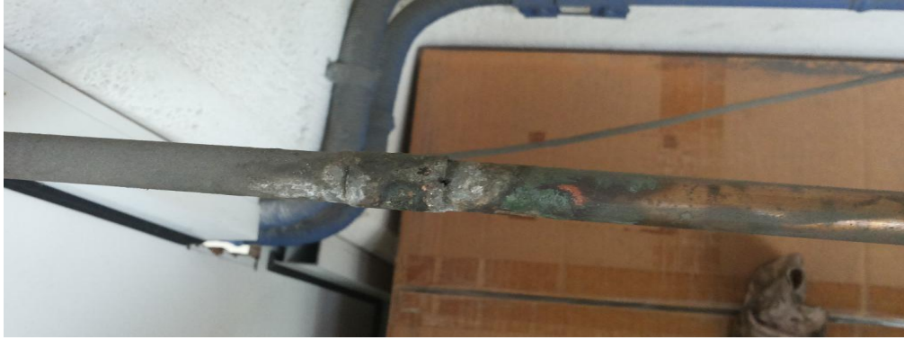
Εικόνα 4.25 Διαρροή του δικτύου με πεπιεσμένο αέρα.
