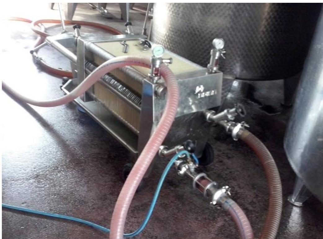
Εικόνα 12 Το μοτέρ – αντλία μεταφοράς νερού από και προς τις δεξαμενές Πηγή : Από επιτόπια φωτογράφιση σε οινοποιητική μονάδα
