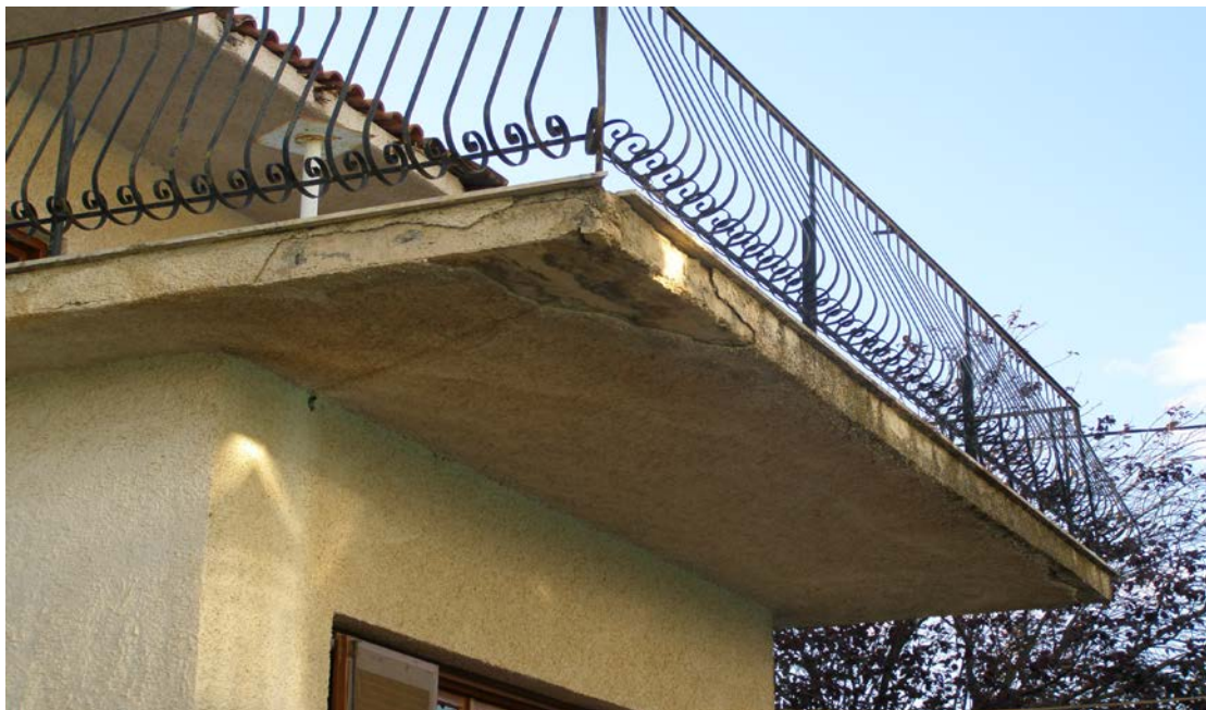
Φ5 ΦΘΟΡΑ ΣΤΙΣ ΑΚΜΕΣ ΤΩΝ ΠΡΟΒΟΛΩΝ ΛΟΓΩ ΤΗΣ ΚΑΚΗΣ ΚΑΤΑΣΚΕΥΗΣ
