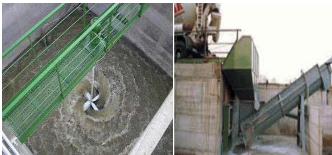
Εικόνα 22 Αναδευτήρας δεξαμενής και ανακύκλωση τύπου κοχλίας
