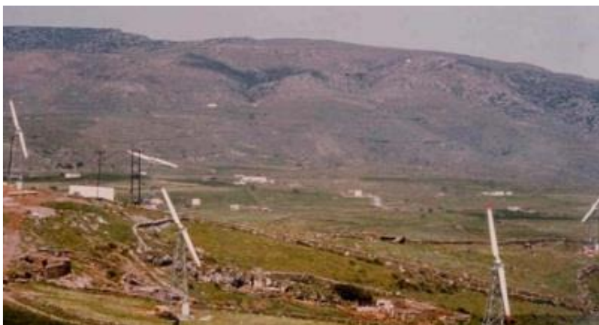
Σχ 1.7 Ανεμογεννήτριες 20KW στο πρώτο αιολικό πάρκο στην Ελλάδα στη νήσο Κύθνο
