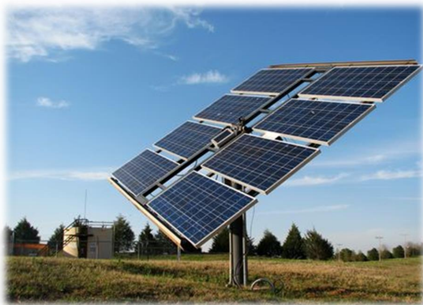
Εικόνα 1. Φωτοβολταϊκό σύστημα παρακολούθησης του ηλίου (tracker)
