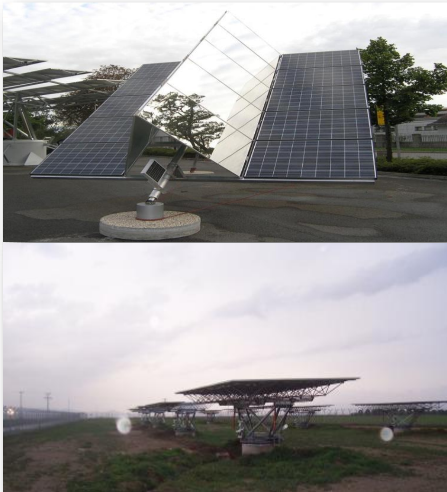
Εικόνα 1.1. Φωτοβολταϊκή συστοιχία σε ηλιοστάτη, με εύρος περιστροφής 140°. Το σύστημα ακολουθεί την πορεία του ήλιου σε ημερήσια βάση με τη βοήθεια ειδικού αισθητήρα
