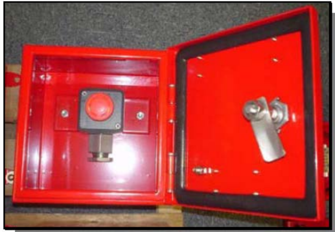
Σταθμός χειροκίνητης ενεργοποίησης συστήματος έκτακτης διακοπής
