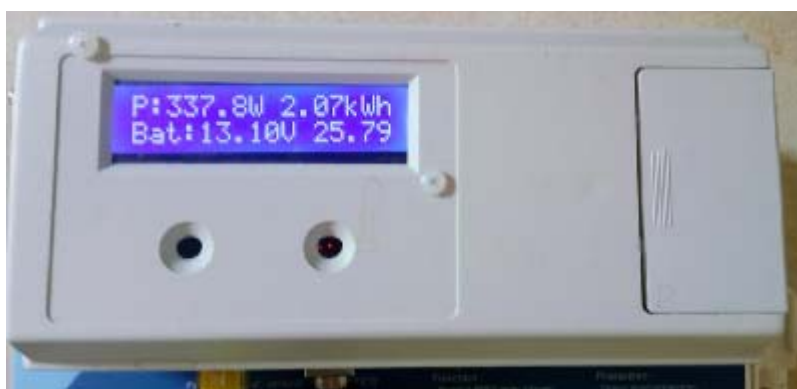
Εικόνα 4.4 Ασύρματο σύστημα ανάγνωσης κατάστασης φωτοβολταϊκού συστήματος.
