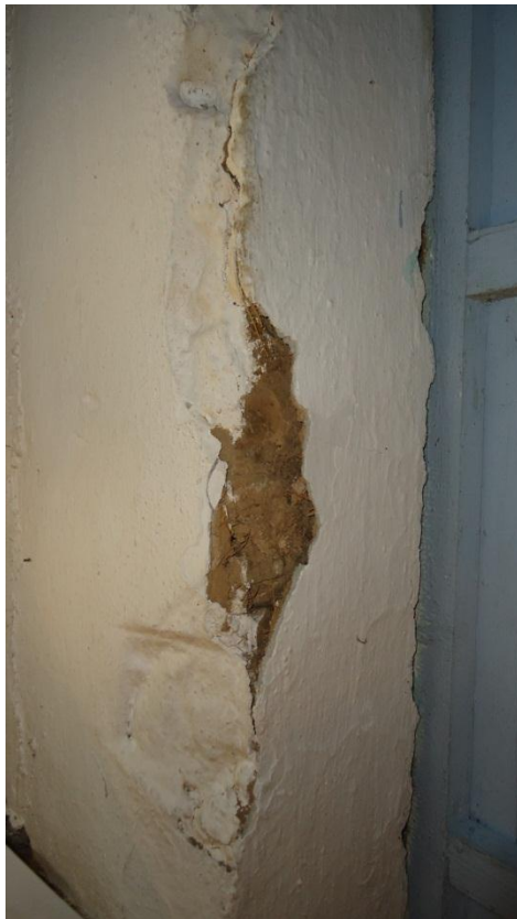
Εικόνα 50 : Η κατοικία έχει υποστεί πολλές φθορές εσωτερικά, κυρίως στα ξύλινα πατώματα, στις ξύλινες οροφές και στο σοβά των τοίχων. Οι φθορές αυτές οφείλονται στην εισροή υγρασίας από την στέγη λόγω εγκατάλειψης και της μη συντήρησης της κατοικίας. (Επι τόπου καταγραφή)
