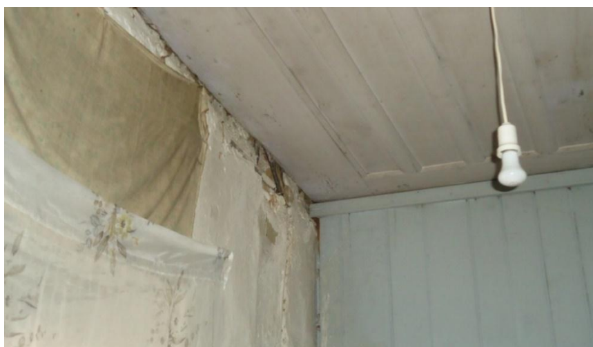
Εικόνα 48 : Όπως φαίνεται στη φωτογραφία υπάρχει κατάρρευση σοβά.
