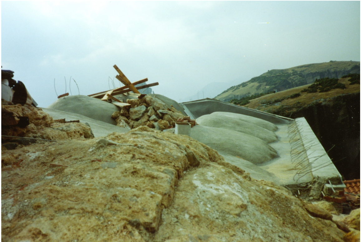
Θόλος με φθαρμένους λίθους. Στο βάθος διακρίνονται οι υπόλοιποι θόλοι που έχουν ήδη επισκευαστεί. Επίσης βλέπουμε και τον οπλισμό του μανδύα δεξιά της φωτογραφίας. Πηγή: Τζήμας Σωτήριος – Ιερά Μονή Αγίου Στεφάνου.
