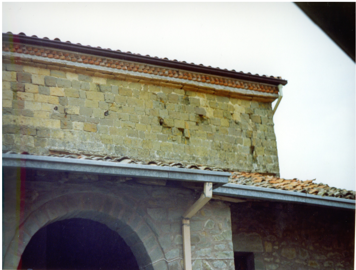
Οι ρυγματώσεις οφείλονται στην αφαίρεση ελκυστήρων.
