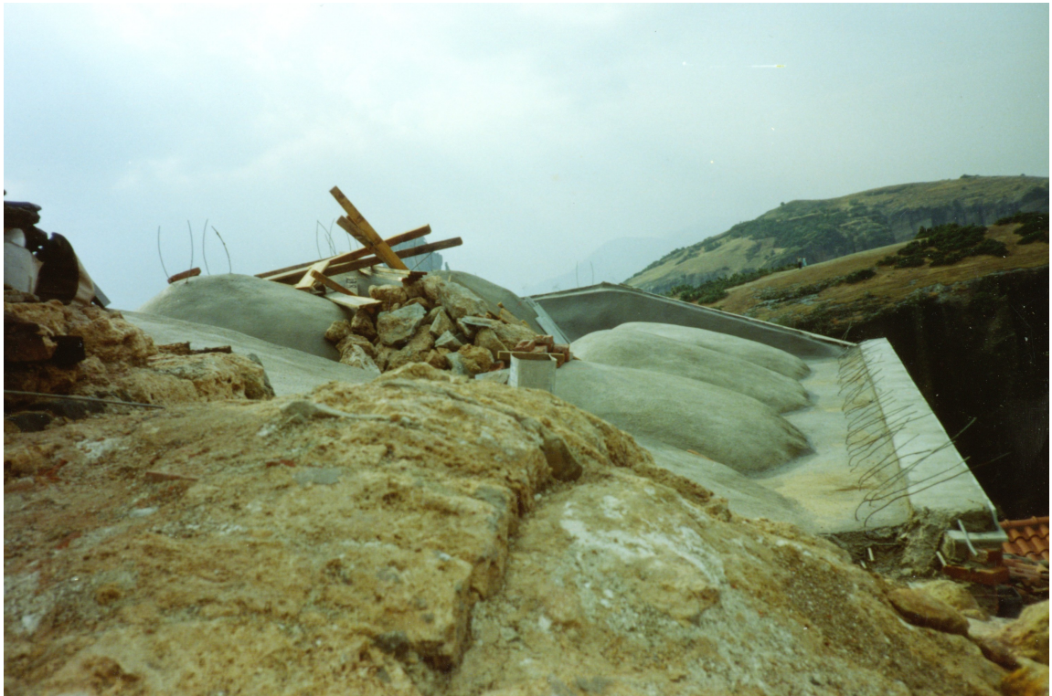
Ένας θόλος πριν την επισκευή του.
