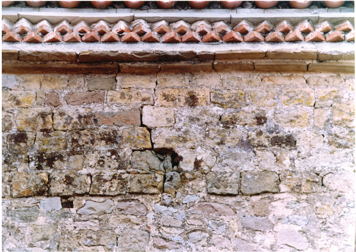
Ρωγμή στην κορυφή της δυτικής πλευράς.
