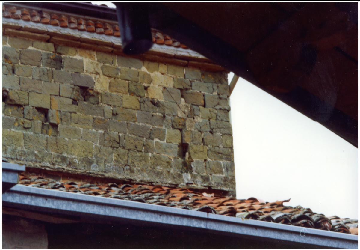
Στο δεξιό τμήμα έχουμε έντονες ρηγματώσεις.
