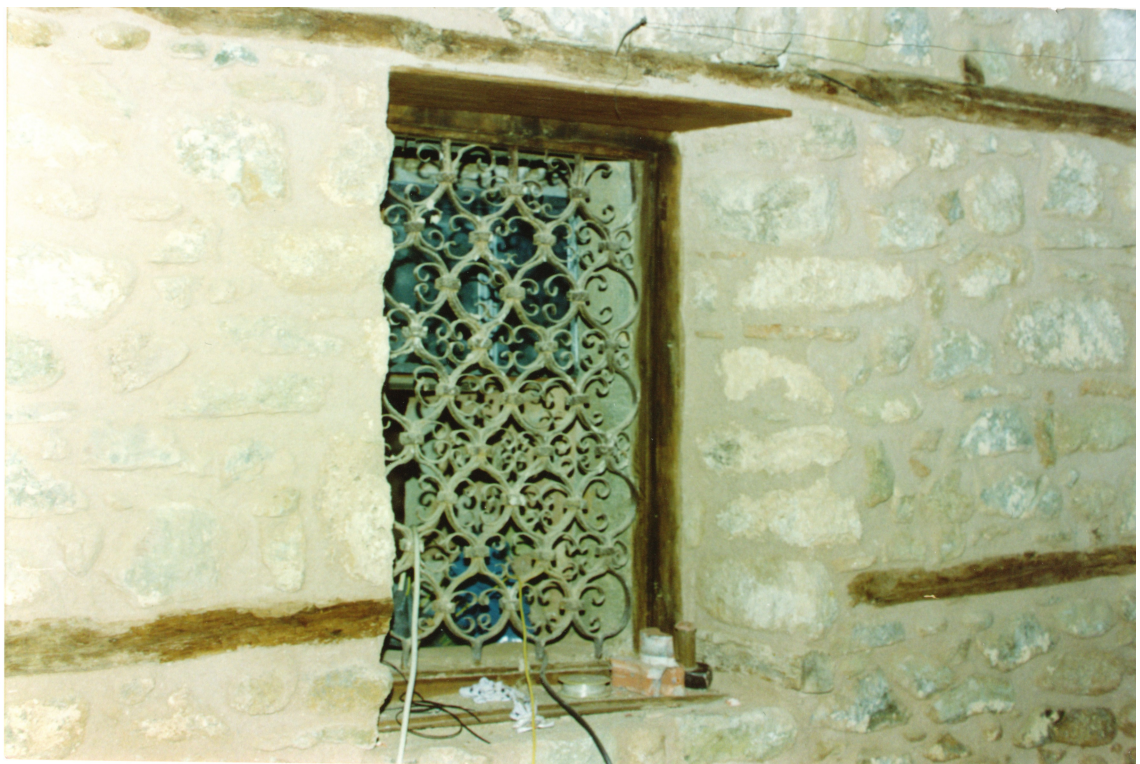
Διακρίνονται πλέον καθαρά τα στοιχεία της κατασκευής του κτηρίου, όπως είναι η ξυλεία που χρησιμοποιείται για την περιδίεση του κτηρίου.
