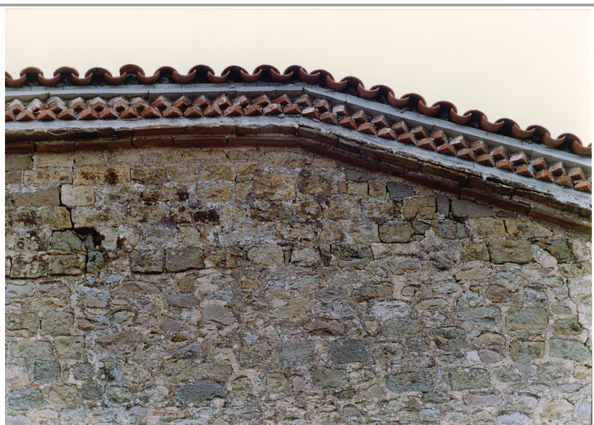
Η φθορά των λίθων στο ύψος του ορόφου.
