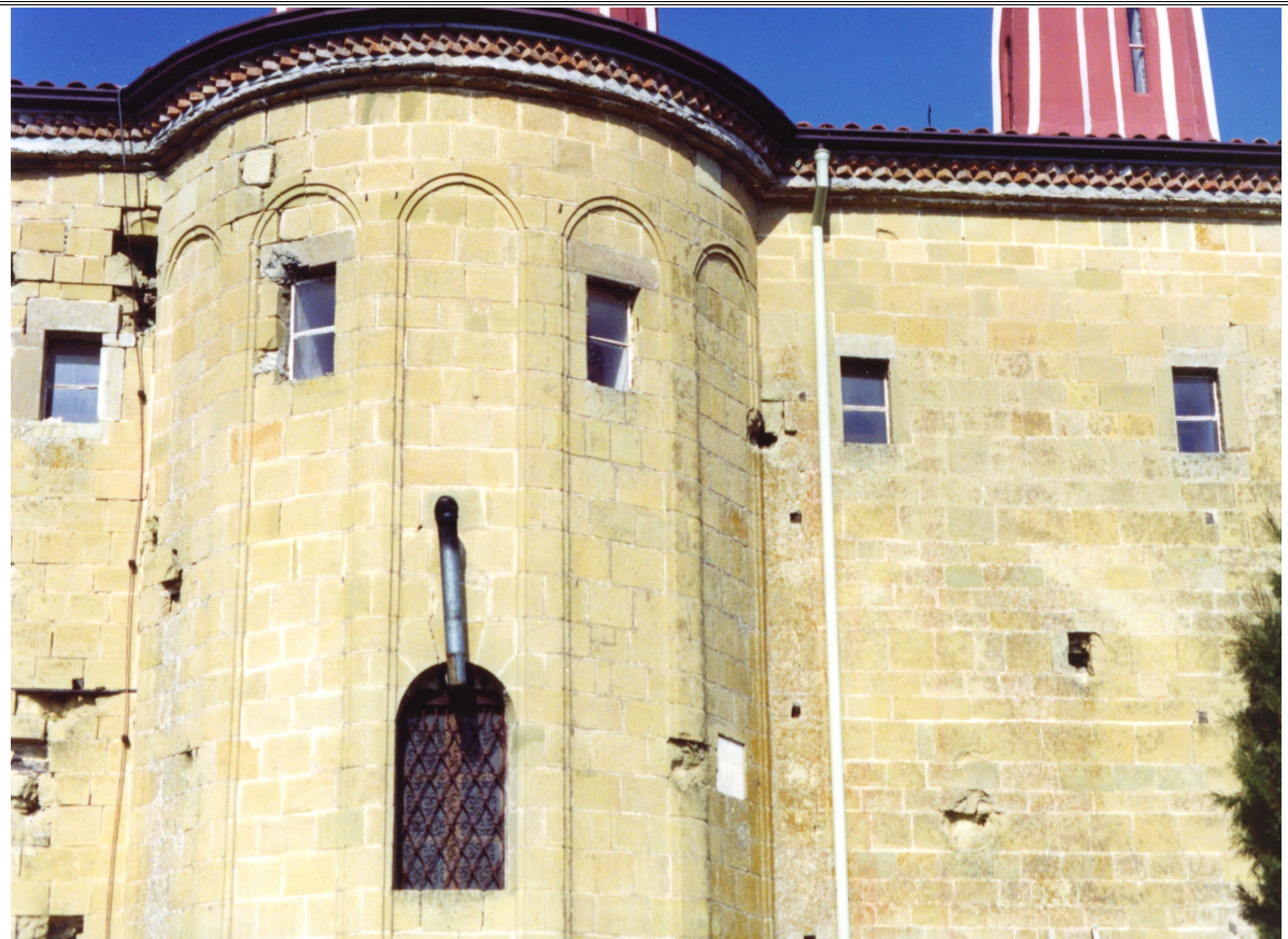
Παρατηρούμε τις φθορές στο κεντρικό τμήμα του τοίχου ακριβώς στο σημείο της δεξιάς κόγχης του ναού λίγο πριν ξεκινήσουν οι εργασίες αποκατάστασης.
