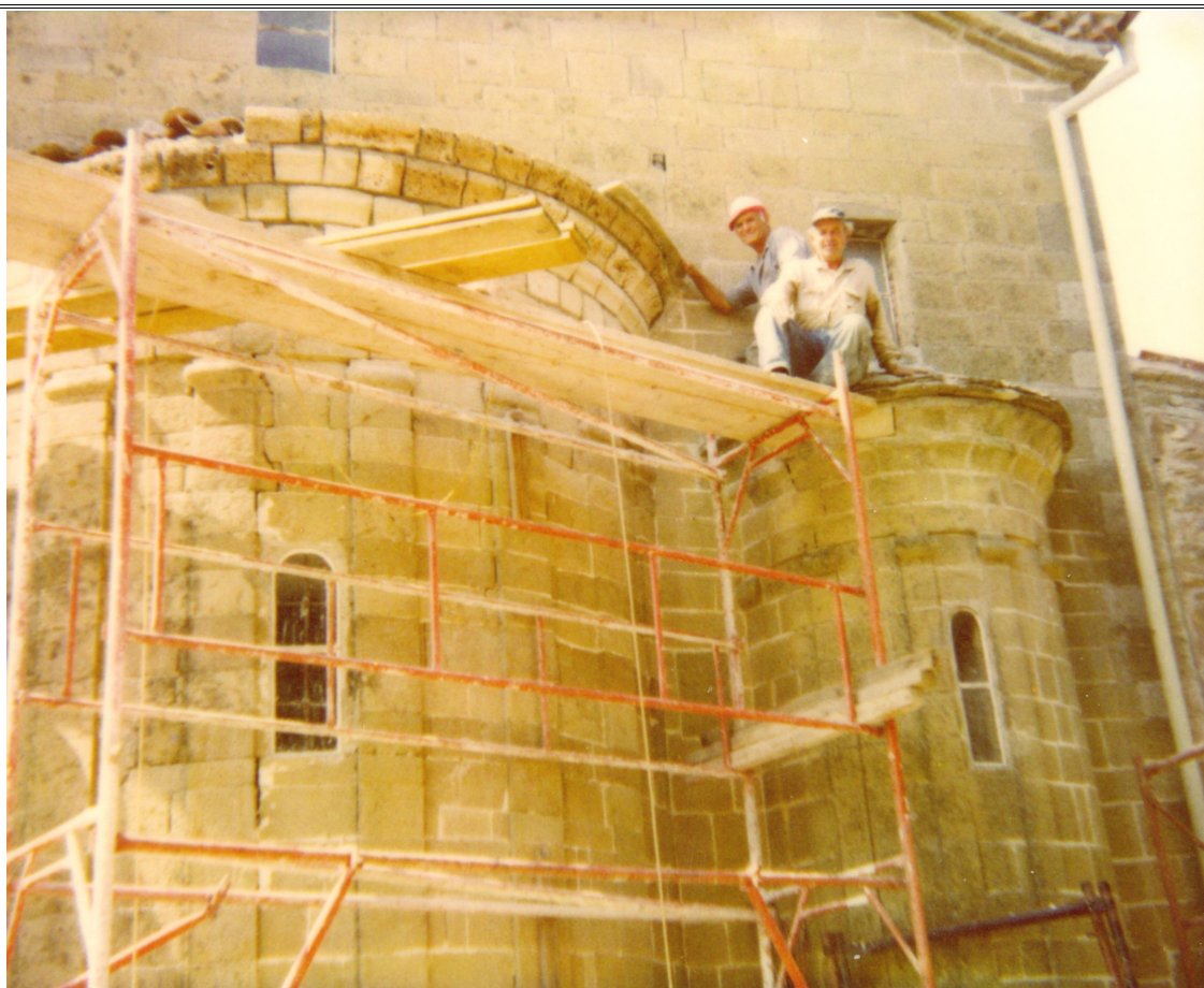
Οι σκαλωσιές στήθηκαν και οι εργάτες αφαιρούν τη στέγη. Πηγή: Τζήμας Σωτήριος – Ιερά Μονή Αγίου Στεφάνου.
