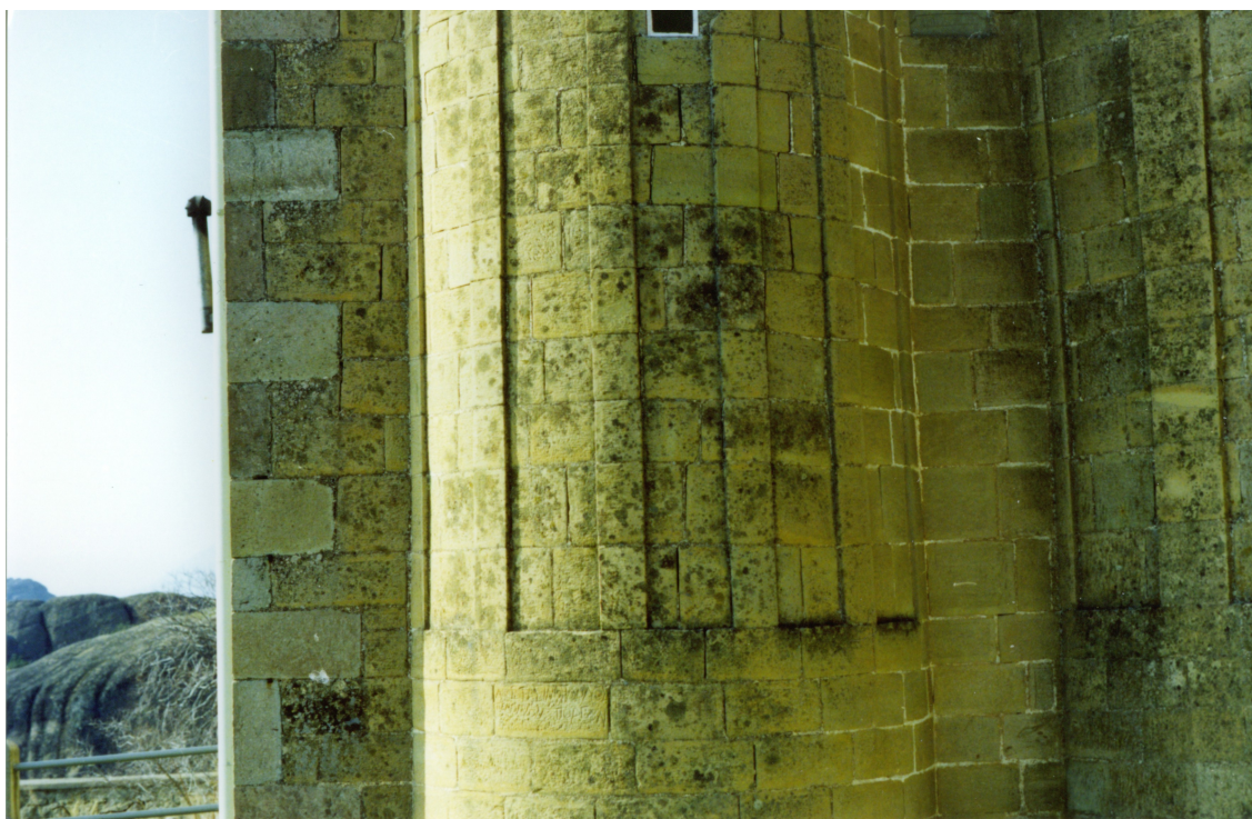
Φθορά στην ένωση με τη νότια πλευρά καθώς και στη κόγχη. Πηγή: Τζήμας Σωτήριος – Ιερά Μονή Αγίου Στεφάνου.
