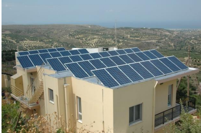
Φωτοβολταϊκά σε σκεπές
