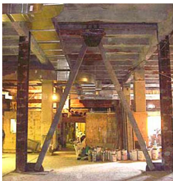
Σχήμα 2.41 Αποσβεστήρες τριβής τοποθετημένοι σε διάταξη \Delta στην κορυφή των μεταλλικών διαγωνίων (Pasquin et al, 2004)
