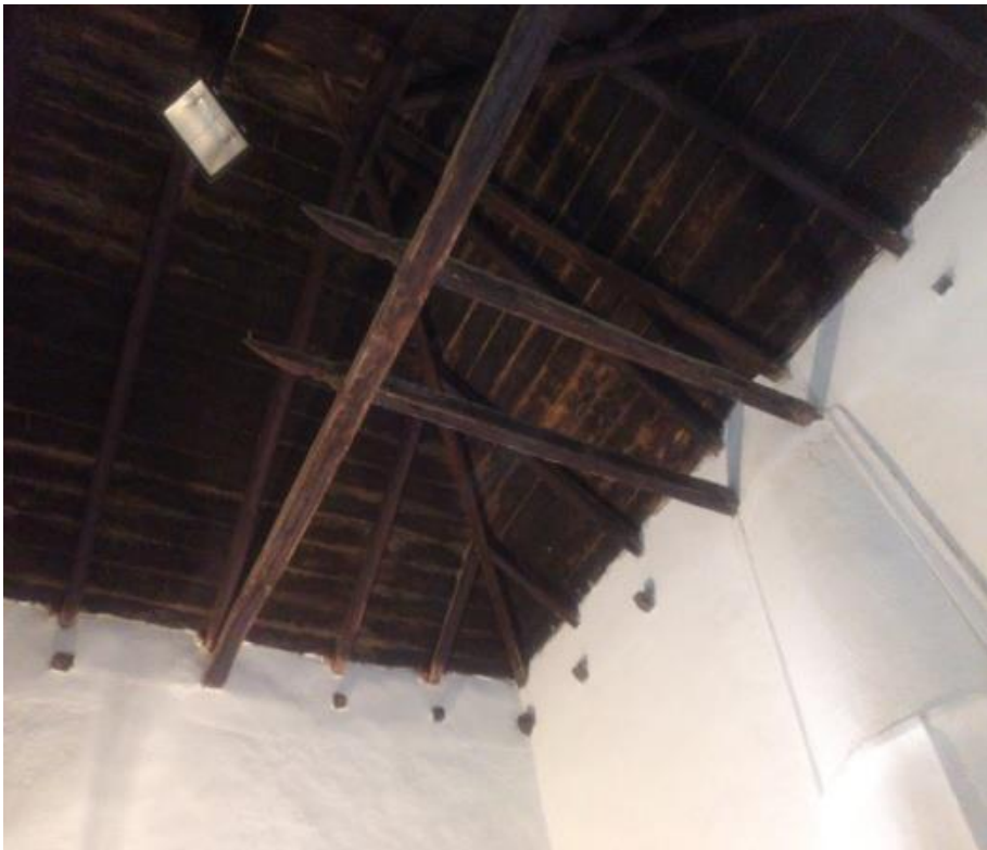
Εικόνα 104: Τα 2 ξύλα που υπάρχουν στη γωνιά καταλήγουν σε δόρατα. Πηγή: Προσωπική λήψη.
