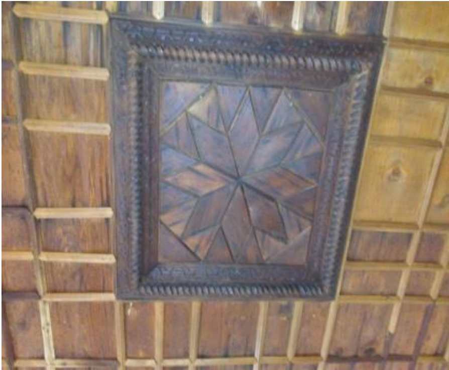
Εικόνα 73: Το ξυλόγλυπτο ταβάνι του Α' Ορόφου. Στην οροφή διακρίνεται ένας ακτινωτός ρόδακας, σύμβολο καλοτυχίας, ευημερίας και αφθονίας. Πηγή: Προσωπική λήψη.
