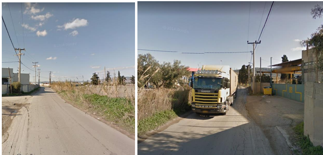
Εικόνα 29 Στην ΒΙΟΠΑ Διλυστηριών. Το οδικό δίκτυο χαρακτηρίζεται από πολλές κακοτεχνίες.
