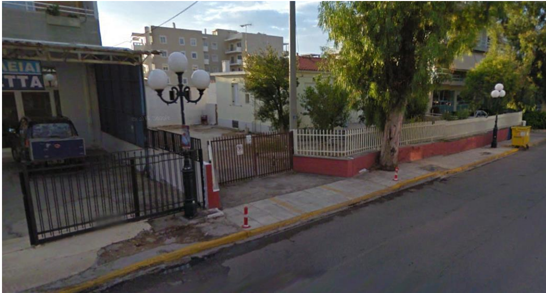
Εικόνα 18 Δύσκολη πρόσβαση πεζών και ατόμων με αμαξίδιο στο πεζοδρόμιο λόγω καταστροφών των πλακών του
