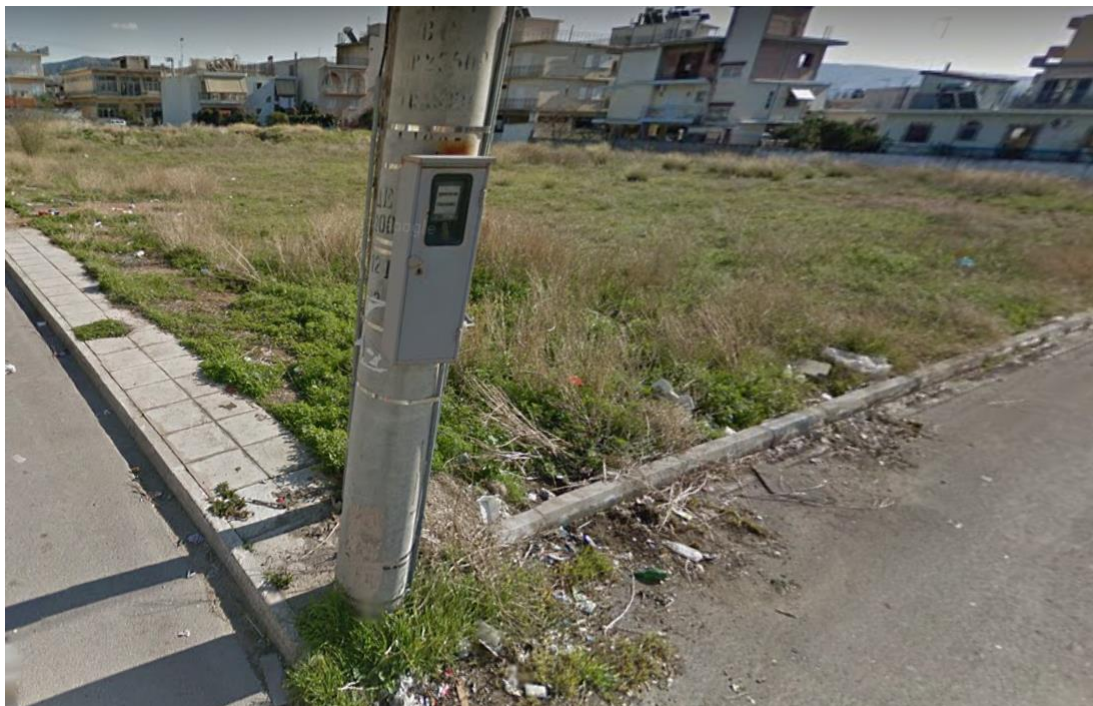
Εικόνα 46 Κακοτεχνία σε πεζοδρόμιο
