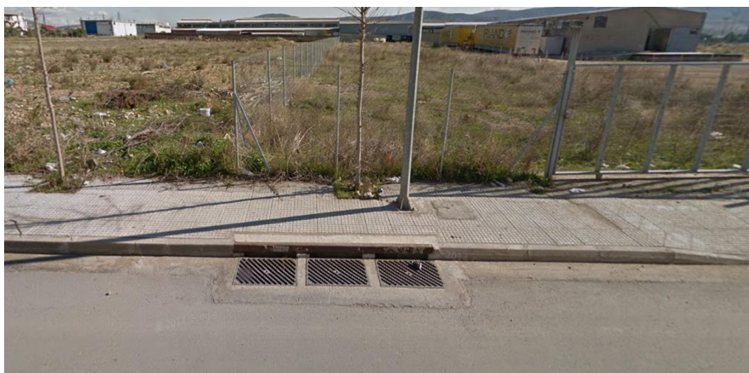
Εικόνα 48 Φρεάτια καθαρά και σε καλή κατάσταση
