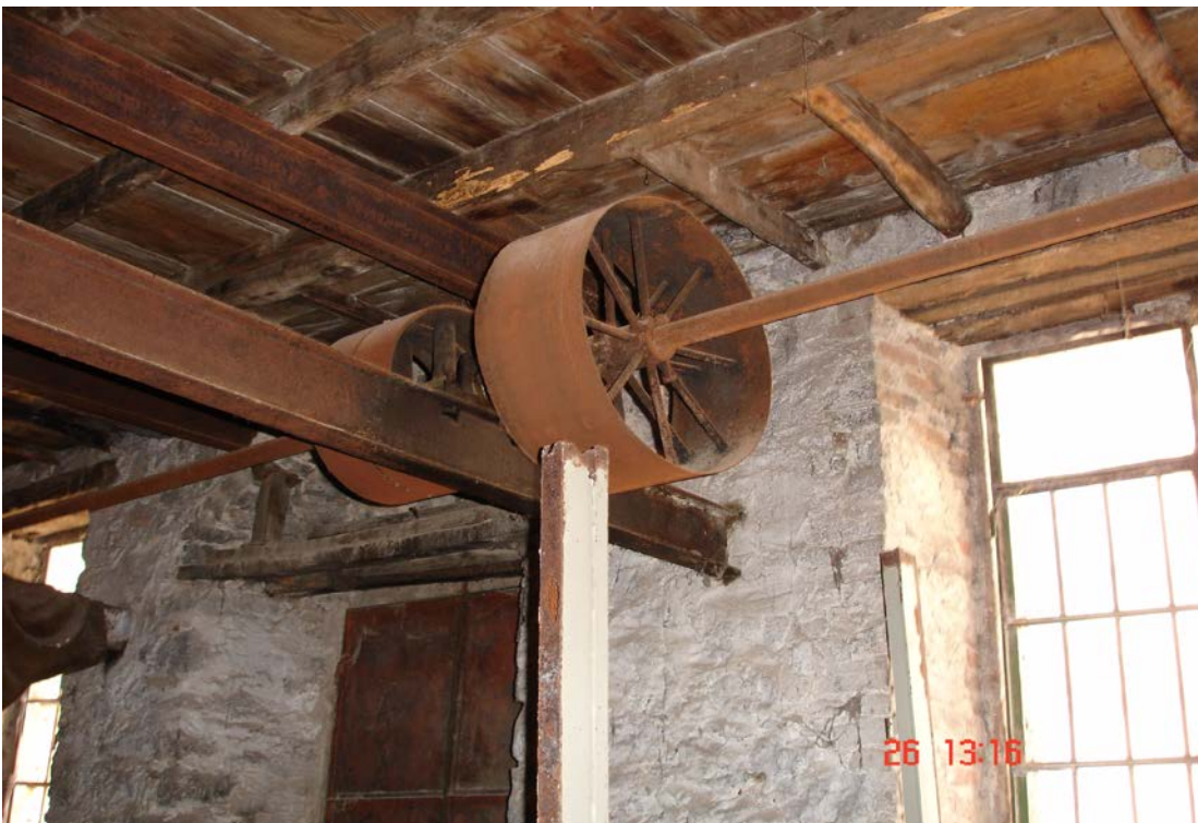
Άξονες και τροχαλίες στηριγμένες στον κυλοδοκο
