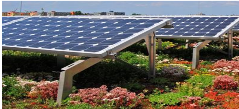
Εικόνα 8 - Φωτοβολταϊκό σύστημα σε φυτεμένο δώμα Πηγή εικόνων:( www.zinco.com )
