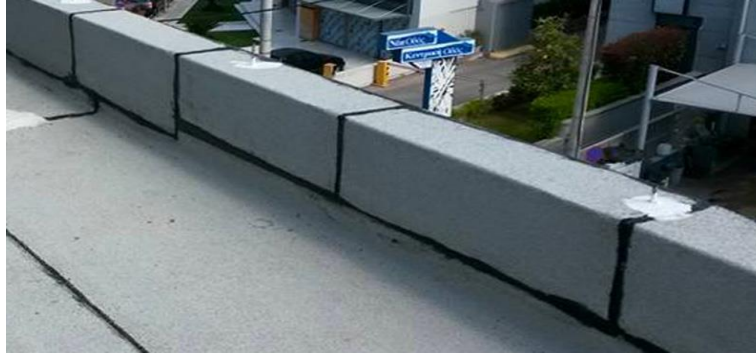
Εικόνα 32 - Στηθαίο δώματος Πηγή εικόνας:( https://www.durostar.gr )
