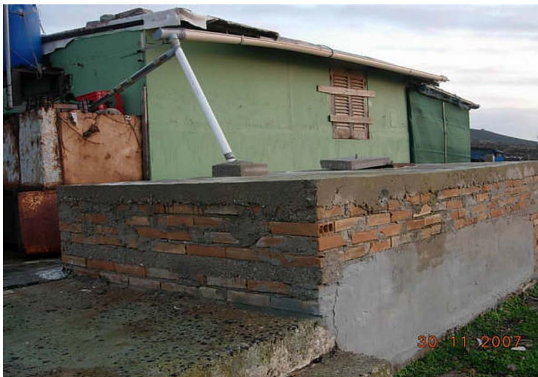
Εικόνα 33 η : Άλλη αυθαίρετη κατασκευή αριστερά του δρόμου στο Α'ΕΤΟ. Διακρίνεται η δεξαμενή νερού η οποία συλλέγει νερό από τις υδρορροές τον χειμώνα.
