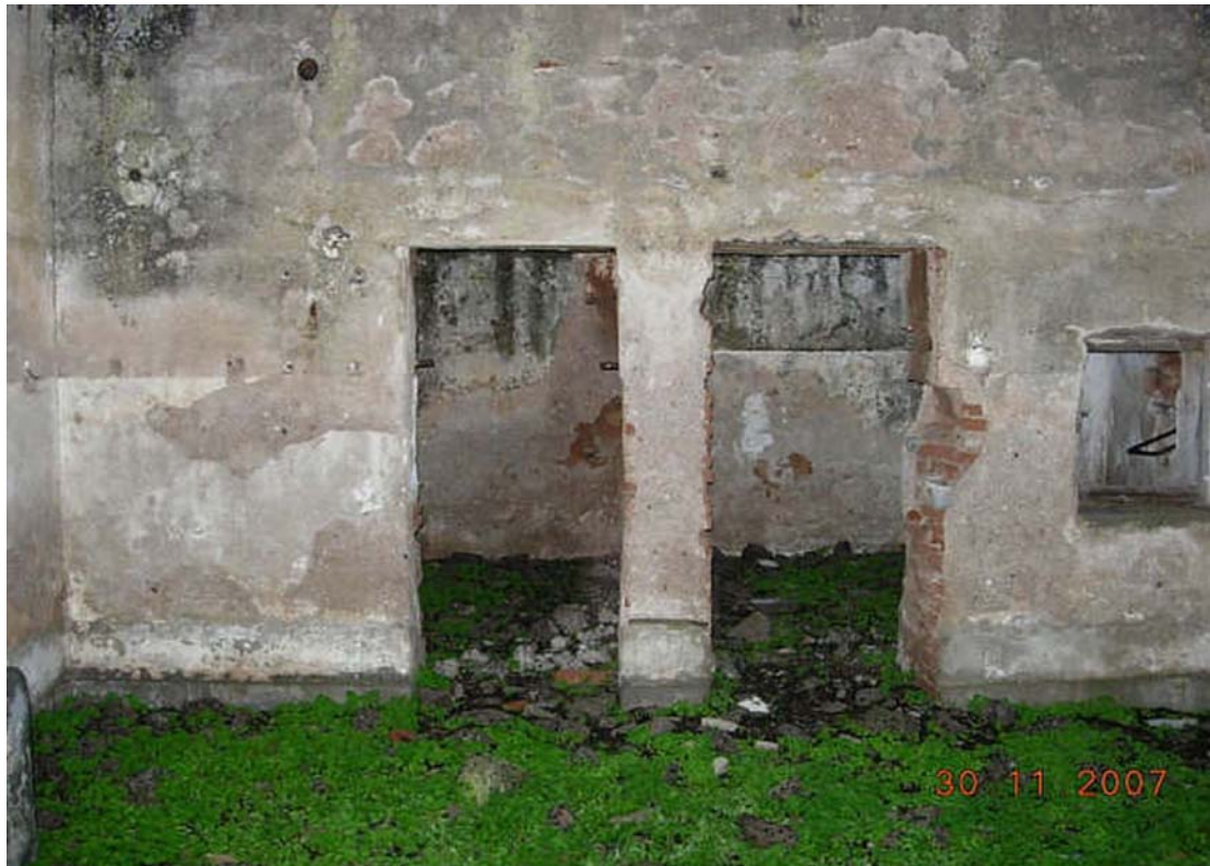
Εικόνα 38 η : Η δεξιά εσωτερική πλευρά του παρασκευαστηρίου. Εσωτερικά διακρίνεται το γκρεμισμένο πλέον πατάρι που υπήρχε.
