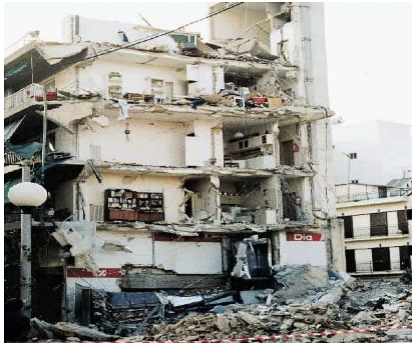
Φωτ. 2.26 Ολοκληρωτική καταστροφή κτιρίου επίκεντρης περιοχής από τον σεισμό. [ πηγή : ηλεκτρονική σελίδα του Οργανισμού Αντισεισμικού Σχεδιασμού και Προστασίας ]
