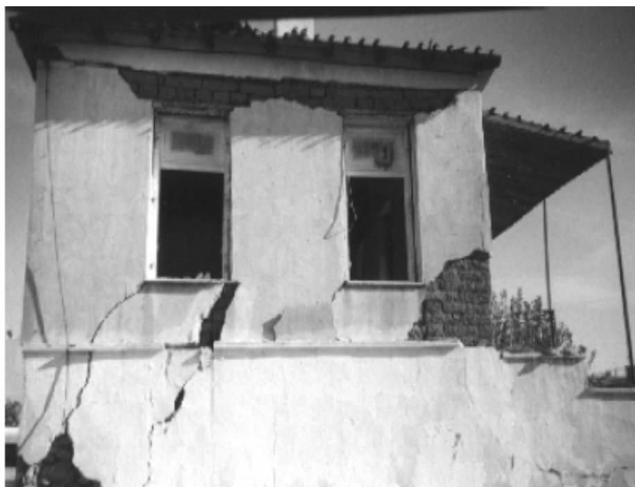
Φωτ. 2.8 Παλαιά κατασκευή από φέρουσα τοιχοποιία, με εμφανείς σημαντικές βλάβες από τον σεισμό. [ πηγή : από τις εργασίες του 6 ου Φοιτητικού Συνεδρίου «Επισκευές Κατασκευών 00» ]
