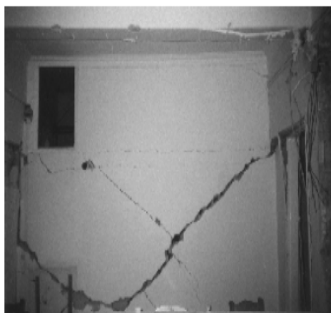
Φωτ. 2.20 Περίπτωση χιαστί ρωγμής
