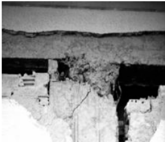
Φωτ. 2.12 Βλάβη στο επάνω μέρος υποστηλώματος, λόγω κάμψης. Συνοδεύεται με αποκάλυψη οπλισμού και μόνιμες παραμορφώσεις.
