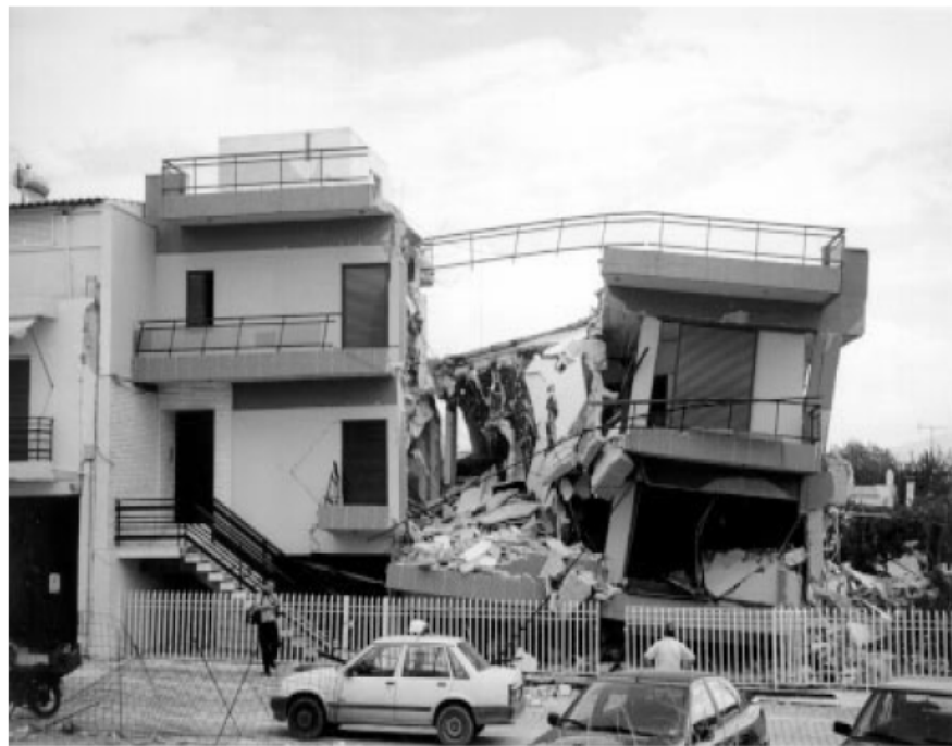
Φωτ. 2.16 Κατάρρευση κτιρίου εξ' αιτίας της αστοχίας των υποστηλωμάτων της πυλωτής.
