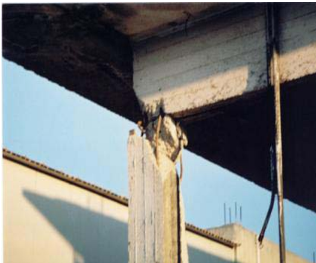
Φωτ. 2.15 Περίπτωση καμπτοδιατμητικής αστοχίας στα άκρα του υποστηλώματος
