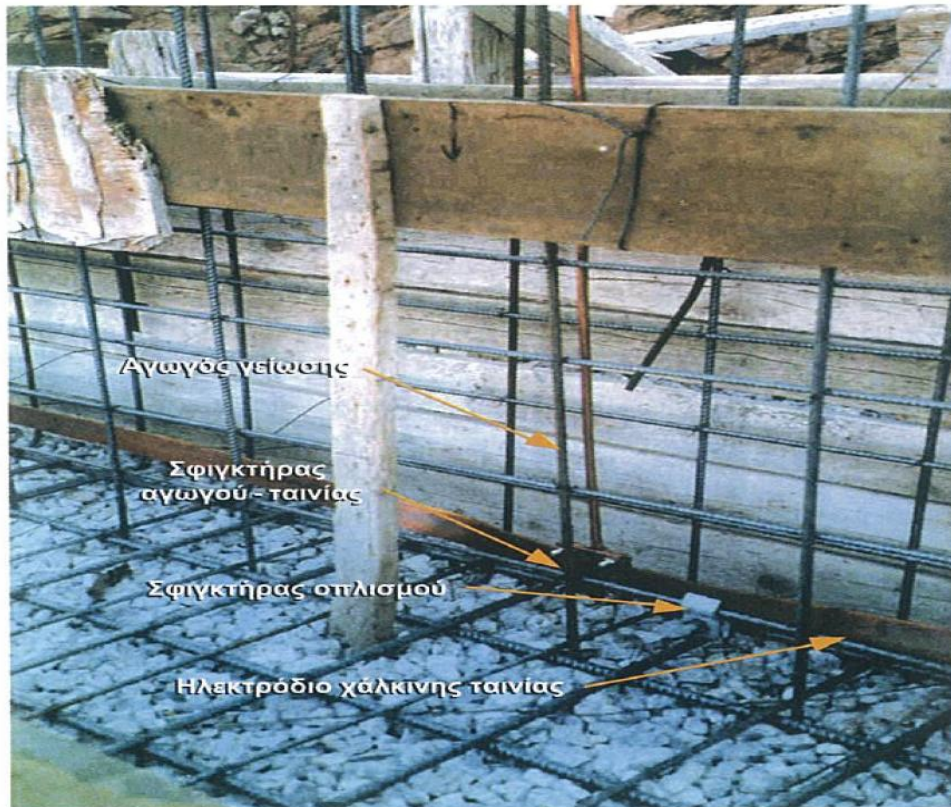
Σχήμα 3.19: Ηλεκτρόδιο θεμελιακής γείωσης με χάλκινη ταινία [15]
