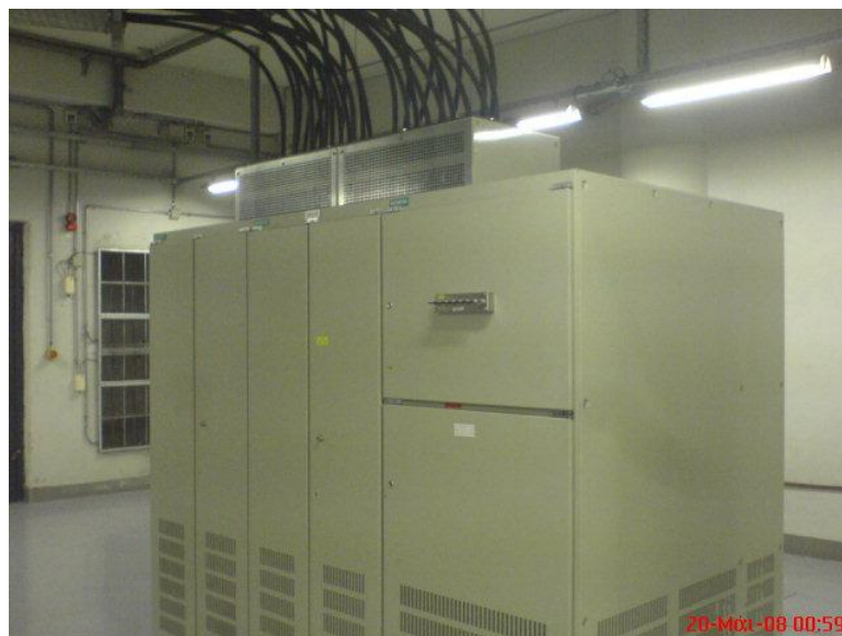
ΑΝΟΡΘΩΤΗΣ Μ.Τ. ΣΤΑΘΜΟΣ ΜΟΝΑΣΤΗΡΑΚΙ
