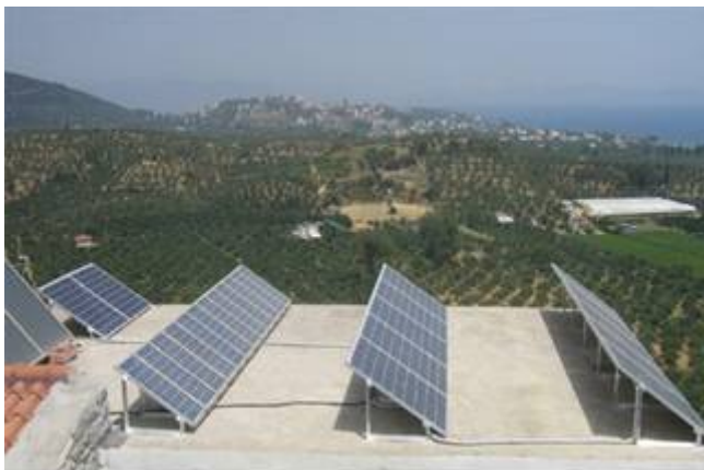
Εικόνα 16 Φωτοβολταϊκή εγκατάσταση σε δώμα
