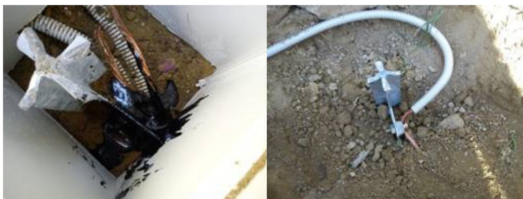
Εικόνα 68 Σύνδεση αγωγού προστασίας με ράβδο εντός φρεατίου και χρησιμοποίηση πίσσας για αύξηση της αγωγιμότητας και βέλτιστη επαφή
