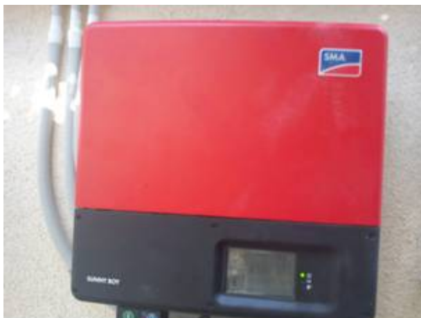
Εικόνα 17 Μετατροπέας διασυνδεδεμένου φωτοβολταϊκού συστήματος
