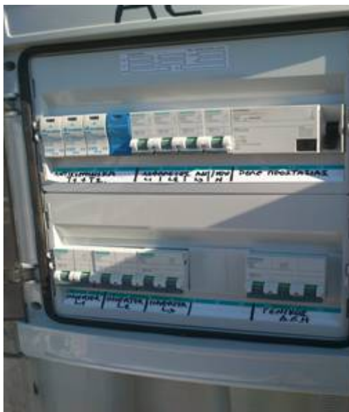
Εικόνα 90 Πίνακας Εναλλασσομένου Ρεύματος
