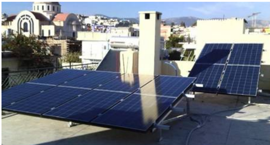
Εικόνα 15 Φωτοβολταϊκή εγκατάσταση σε ταράτσα με εμφανείς σκιάσεις των πάνελ
