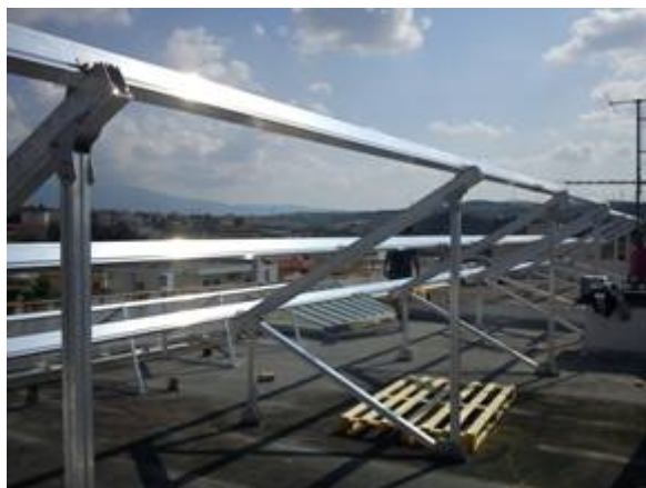
Εικόνα 34 Μεταλλική βάση στήριξης πλαισίων σε δώμα
