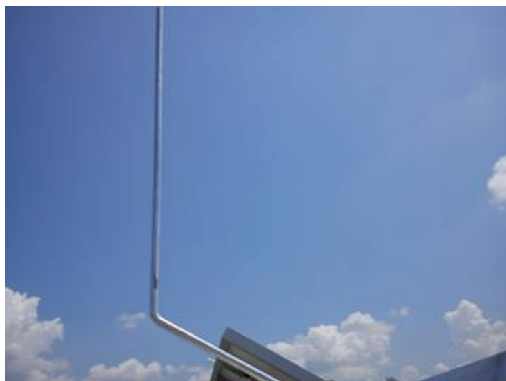
Εικόνα 72 Ακίδα σύλληψης άμεσου κεραυνικού πλήγματος
