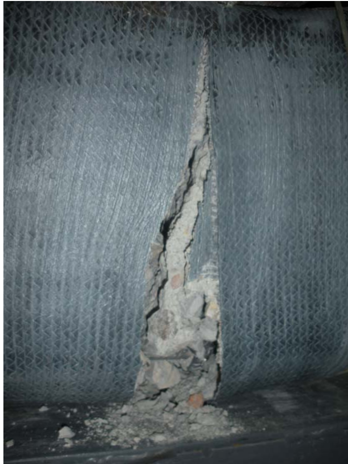
ΕΙΚ.34)Θραύση σκυροδέματος από καμπτικό εφελκυσμό
