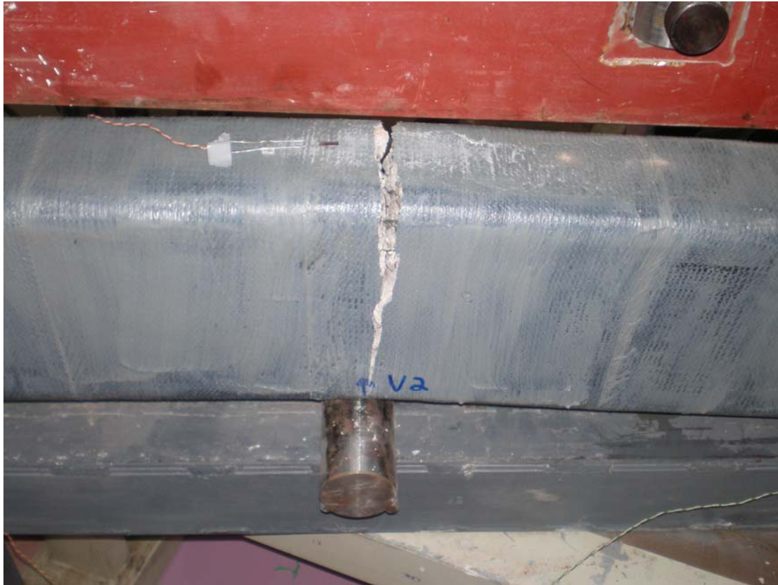
ΕΙΚ.32)Καμπτική αστοχία, θραύση του υφάσματος στη κεντρική στήριξη
