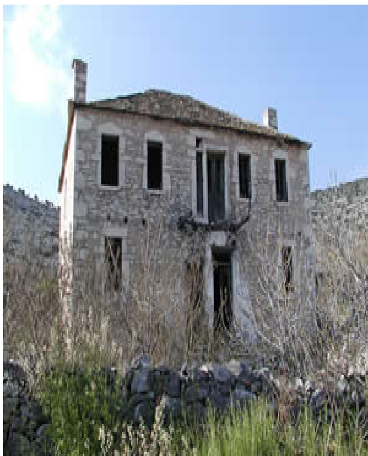
ΦΩΤΟΓΡΑΦΙΑ 1 Αρχοντικό με ρηγματώσεις στην τοιχοποιία.*
