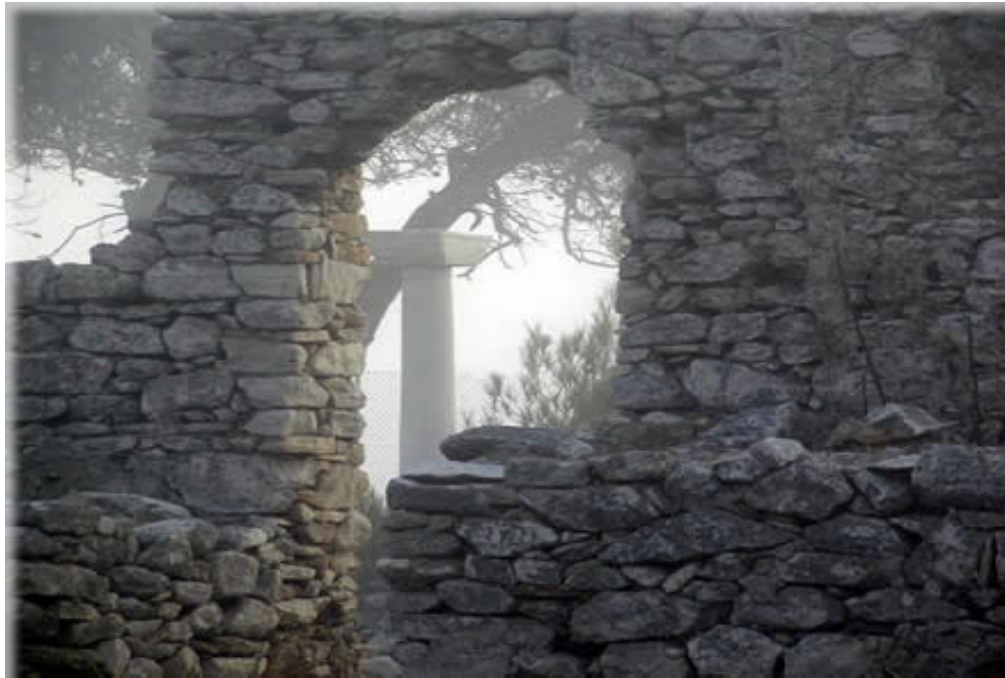
ΦΩΤΟΓΡΑΦΙΑ 4 Ρηγματώσεις υπερθύρων στην τοιχοποιία
