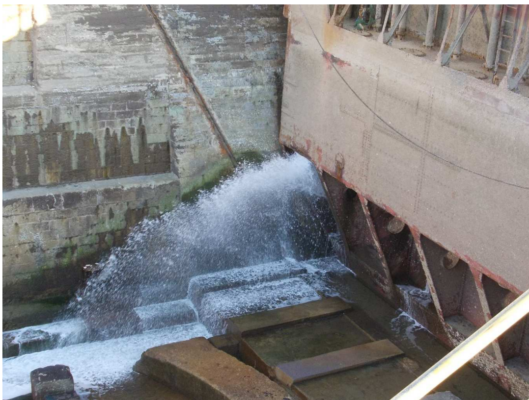
Εικόνα 36 Εμφανής βλάβη στο κινητό φράγμα της δεξαμενής με αποτέλεσμα την εισροή υδάτων
