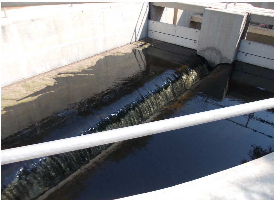
Εικόνα 16 Άποψη του επεξεργασμένου νερού που χύνεται στο Σαρωνικό
