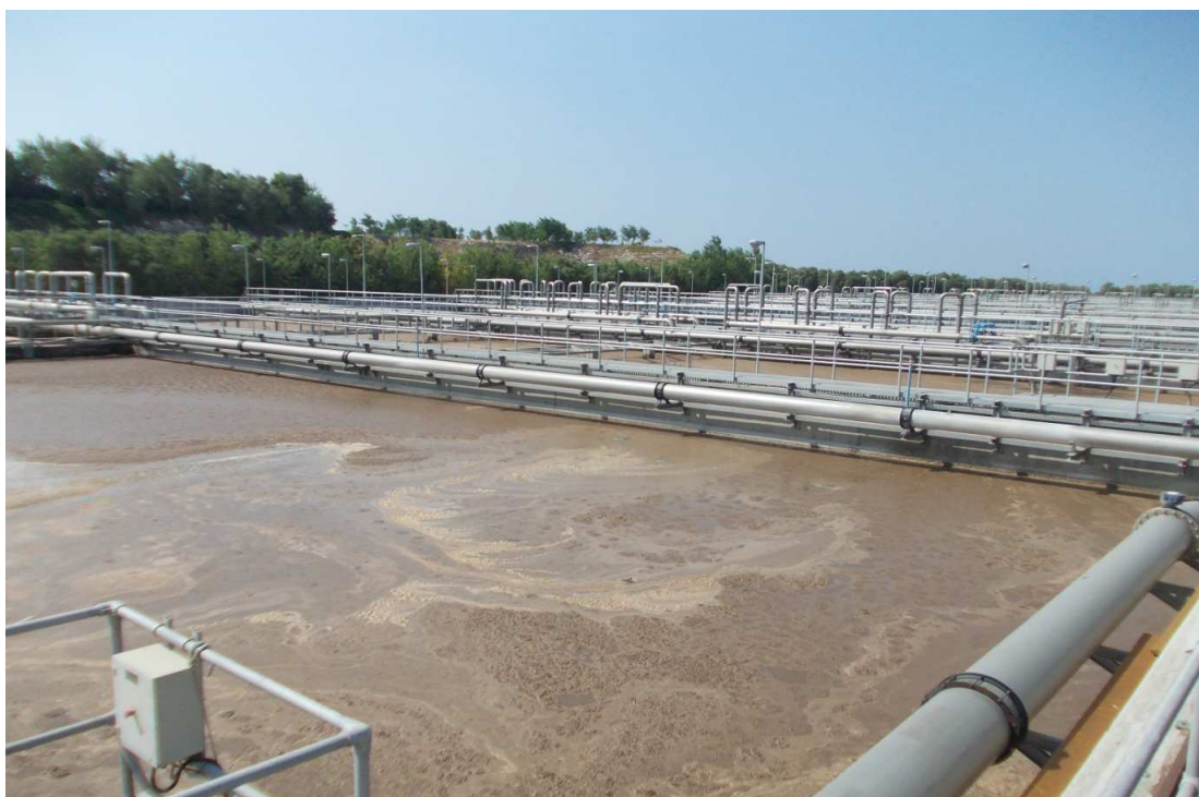
Εικόνα 15 Άποψη των 64 δεξαμενών δευτεροβάθμιας επεξεργασίας
