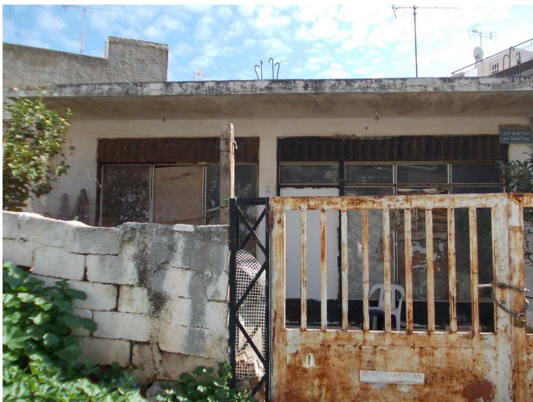
Εικόνα 55 Εγκαταλελειμμένο κτίσμα στο Άνω Πέραμα. Άλλο ένα συχνό φαινόμενο στην περιοχή
