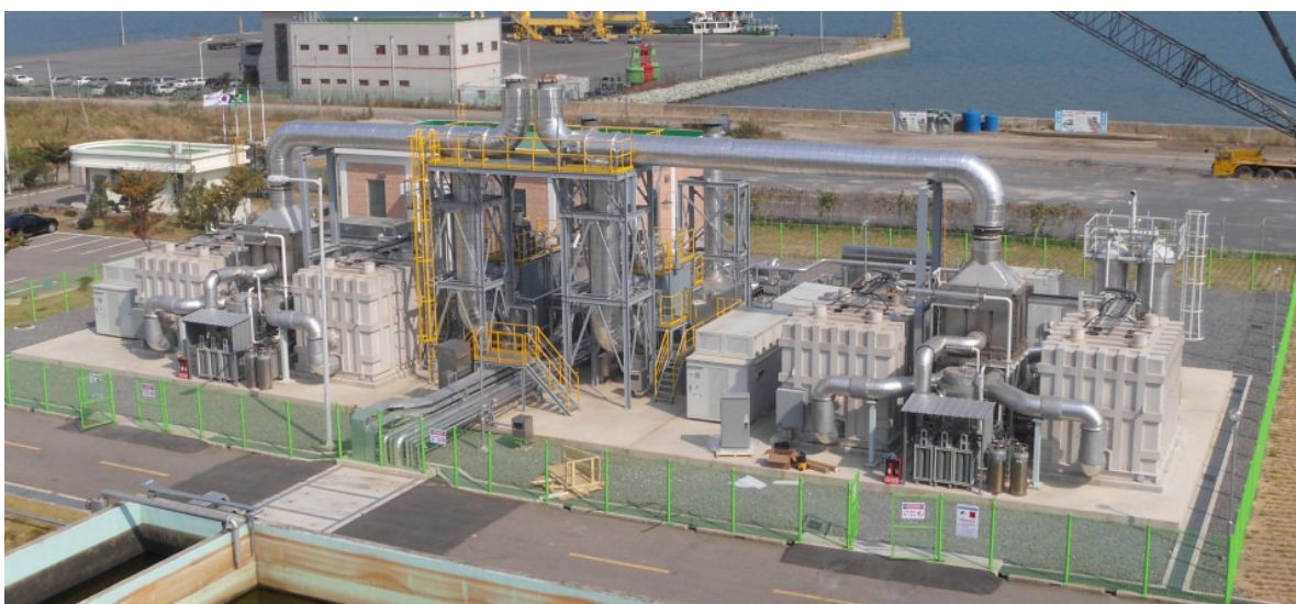
Εικόνα 36. Κυψέλη καυσίμου τήγματος ανθρακικών αλάτων στη Νότια Κορέα, ισχύος 4.8MW.
