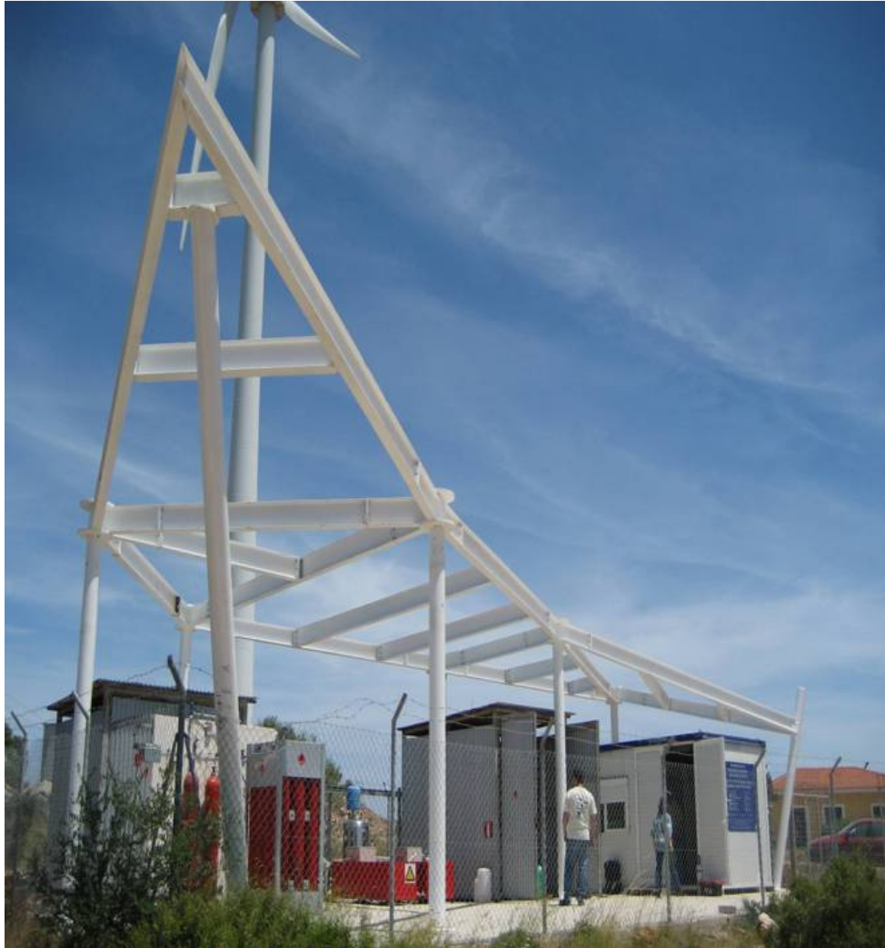
Εικόνα 59. Περιμετρική άποψη των εγκαταστάσεων υδρογόνου του ΚΑΠΕ στο Λαύριο. Σε πρώτο πλάνο φαίνονται τα υποσύστημα της εγκατάστασης, ενώ στο βάθος διακρίνουμε τον πύργο της ανεμογεννήτριας που χρησιμοποιείται για την παροχή ηλεκτρικής ενέργειας.
