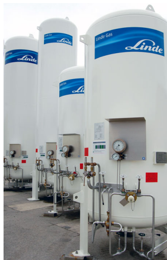
Εικόνα 8. Δεξαμενή αποθήκευσης κρυογονικού υδρογόνου της εταιρίας Linde. Τα μεγέθη κυμαίνονται από 3.000 – 100.000 λίτρα.
