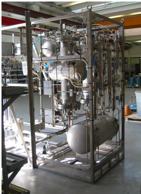
Εικόνα 63. Η μονάδα ηλεκτρόλυσης στην εγκατάσταση του ΚΑΠΕ.
