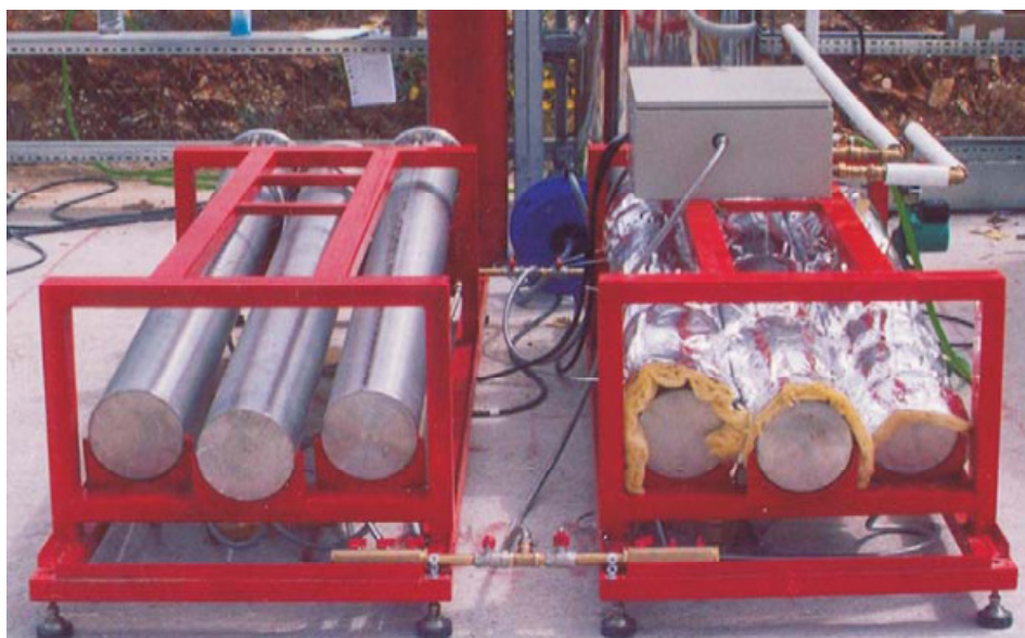
Εικόνα 64. Εγκατεστημένες δεξαμενές μεταλλοϋδριδίων στις εγκαταστάσεις υδρογόνου του ΚΑΠΕ.
