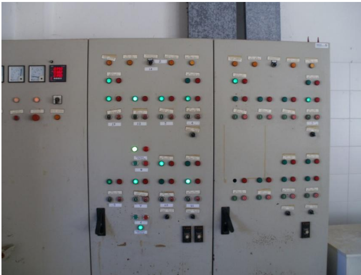
Εικόνα 34. Πίνακας ελέγχου μονάδος αφυδάτωσης.
