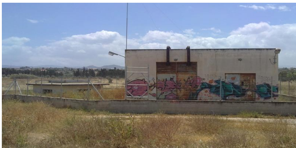
Εικόνα 14. Αντλιοστάσιο συγκέντρωσης και μεταφοράς Λυμάτων το οποίο ευρίσκεται στην τοποθεσία Ποσειδωνία-Κορίνθου. Στο εσωτερικό του υπάρχουν όργανα ελέγχου και συστήματα αυτοματισμού τα οποία διακρίνονται στην εικόνα 15.
