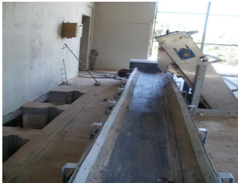
Εικόνα 19. Μεταφορική ταινία. Η μεταφορική ταινία αποτελεί κύριο μέρος του συστήματος αυτοματισμού ο οποίος ευρίσκεται στην είσοδο υποδοχής λυμάτων της Εγκατάστασης και στόχος του είναι η απομάκρυνση των σωματιδίων. Τα οποία είναι ευμεγέθη.
