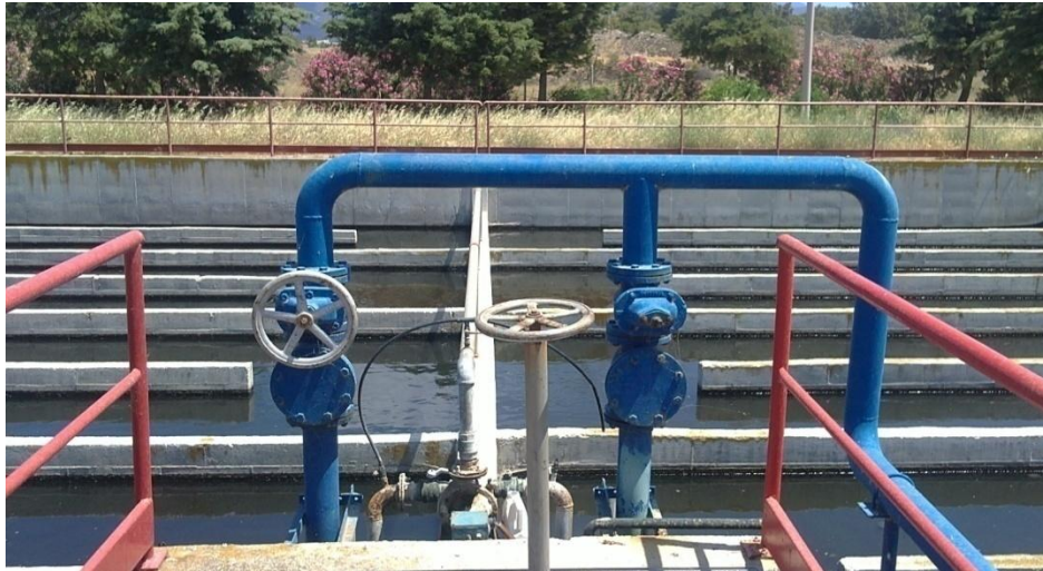
Εικόνα 36. Αντλίες οι οποίες χρησιμεύουν στην μεταφορά διευγασμένης εκροής(βιομηχανικό νερό) από την δεξαμενή χλωρίωσης στην οποία ευρίσκονται, στην δεξαμενή αφυδάτωσης..
