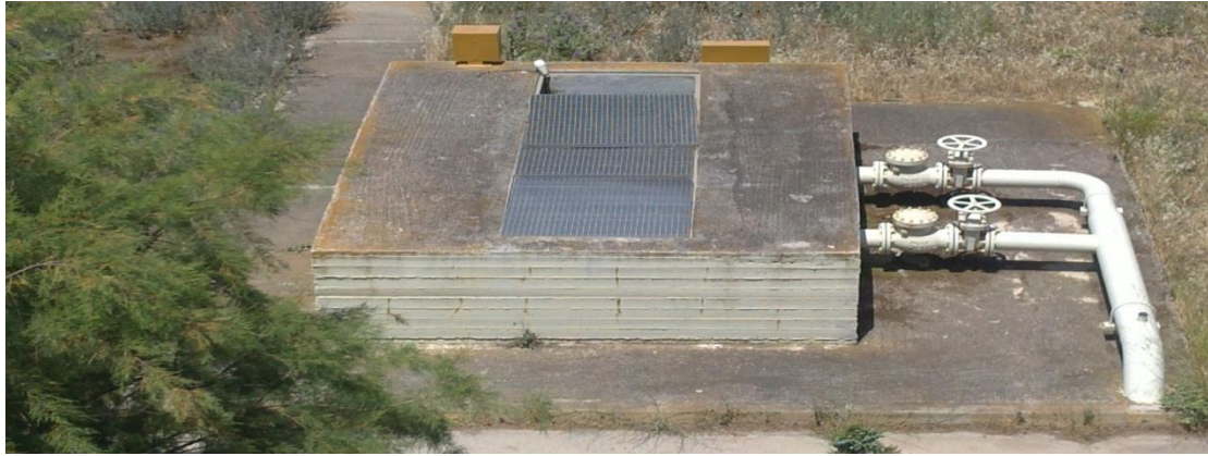
Εικόνα 50. Μέσω του αντλιοστασίου εκκένωσης περίσσεια ιλύος ανακατευθύνεται στην προεπεξεργασία της Εγκατάστασης Επεξεργασίας Λυμάτων.
