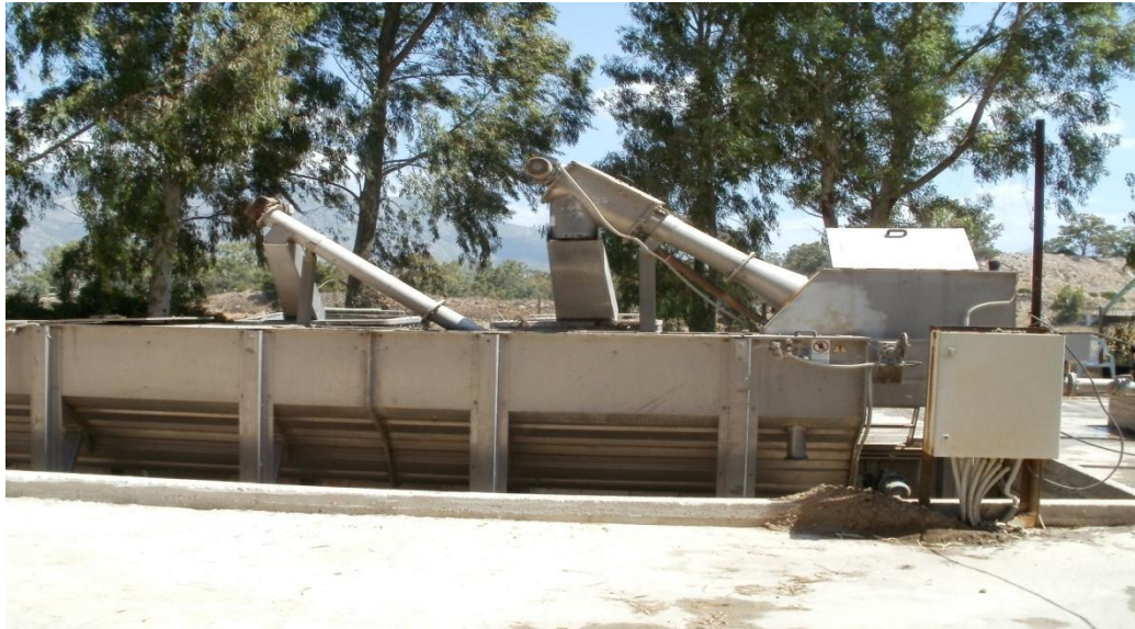
Εικόνα 46. Δεξαμενή υποδοχής βοθρολυμάτων. Τα βυτιοφόρα αδειάζουν τα λύματα στην δεξαμενή και τα συστήματα αυτοματισμών ανακατευθύνουν τα λύματα στην κεντρική εγκατάσταση ύστερα από προεπεξεργασία.
