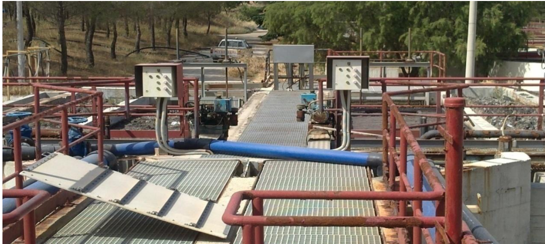
Εικόνα 21. Γέφυρα εξάμωσης. Στο εσωτερικό της υπάρχουν τα συστήματα αφαίρεσης των επιπλέον ανεπιθύμητων σωματιδίων(λίπη-έλαια) τα οποία δεν μπορούν να αφαιρεθούν στην προηγούμενη μονάδα.
