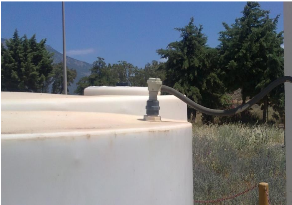
Εικόνα 33. Αισθητήρια στάθμης ποσοτικού ελέγχου χλωριούχου διαλύματος, που είναι τοποθετημένα στο δοχείο παροχής διαλύματος χλωρίου στην δεξαμενή χλωρίωσης.
