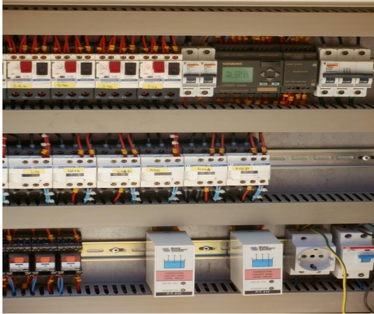
Εικόνα 47. Πίνακας ελέγχου μονάδας βοηθολυμάτων. Το μαύρο κουτί επάνω δεξιά είναι το PLC έχει σαν σκοπό την ασφαλή και οικονομική λειτουργία της μονάδος, ενώ τέρμα κάτω υπάρχουν δυο αισθητήρια, δίπλα στην πρίζα.
