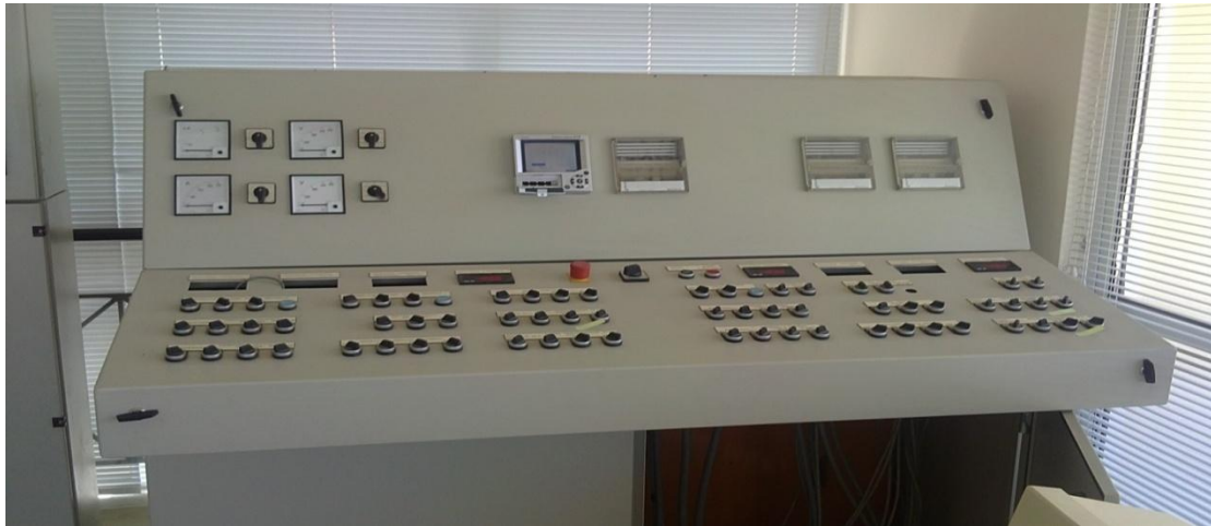
Εικόνα 53. Τράπεζα ελέγχου όλης της Εγκατάστασης. Σε περίπτωση δυσλειτουργίας μας δίνει την δυνατότητα λήψης μέτρων για την προσωρινή διευθέτηση του προβλήματος
