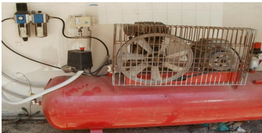
Εικόνα 37. Αεροσυμπιεστής πρεσών. Τροφοδοτεί με αέρα την μονάδα αφυδάτωσης.
