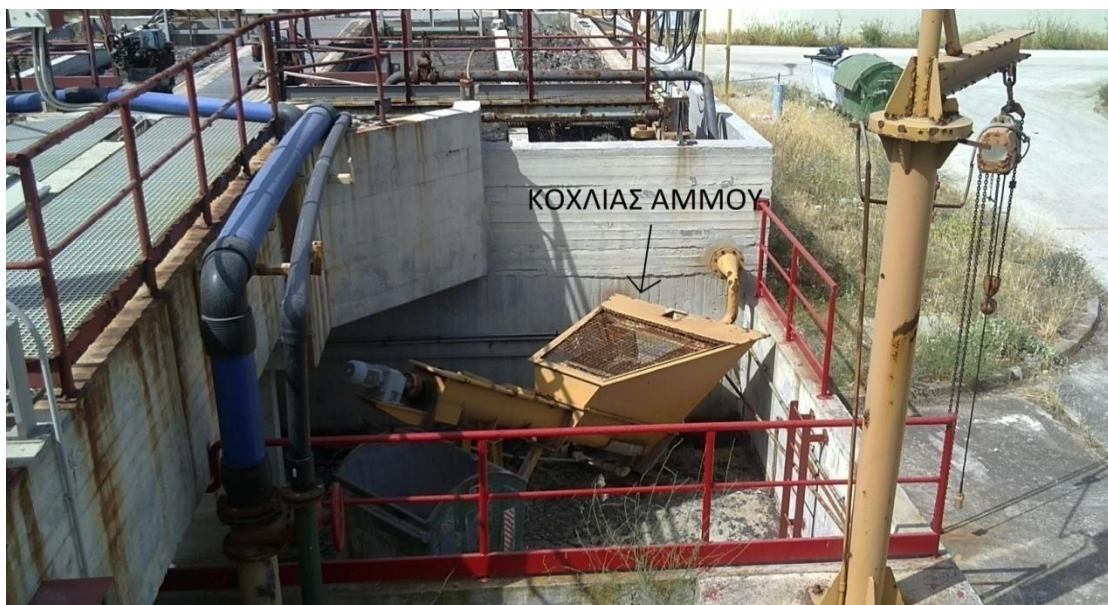
Εικόνα 22. Το αιώρημα άμμου-λυμάτων μεταφέρεται στον κοχλία άμμου όπου πραγματοποιείται ο διαχωρισμός του μίγματος και η μεταφορά της άμμου σε κάδους απομάκρυνσης.
