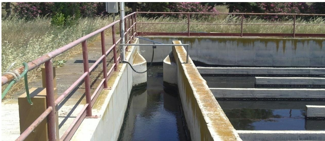
Εικόνα 31. Διάταξη Venturi στην είσοδο της δεξαμενής χλωρίωσης. Διακρίνεται στην φωτογραφία το σύστημα αυτόματης καταγραφής της παροχής επεξεργασμένης εκροής.
