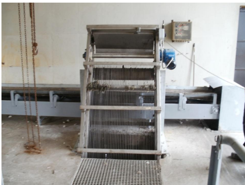
Εικόνα 17. Ηλεκτροκίνητη μηχανική εσχάρα η οποία ευρίσκεται στο στάδιο της προεπεξεργασίας λυμάτων της εισόδου της εγκατάστασης.
