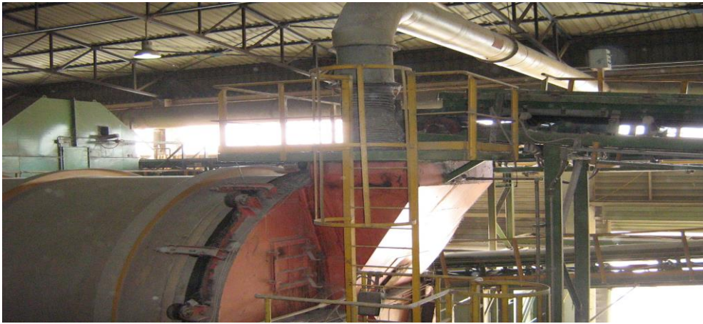
Εικόνα 27: Στην πάνω μέρος της εικόνα φαίνεται η λευκή σωλήνα του συστήματος αποκονίωσης στην είσοδο του βιοκολίνδρου.
