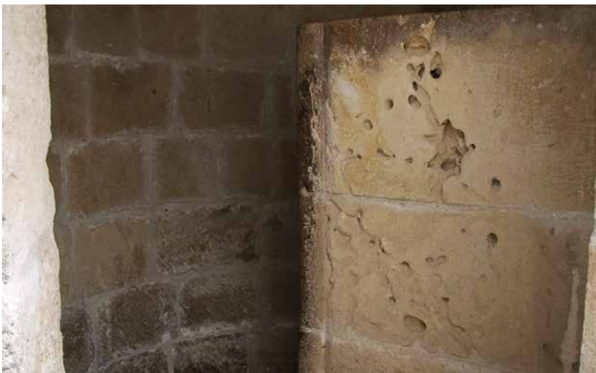
Εικόνα 110: Αντικατάσταση κατεστραμμένων λίθων με νέους και εφαρμογή νέων κονιαμάτων συγκόλλησης σε εσωτερικό κυκλικό τοίχο του 2 ου ορόφου του κάστρου του Κολοσσίου. (Προσωπική λήψη 22/3/09).
