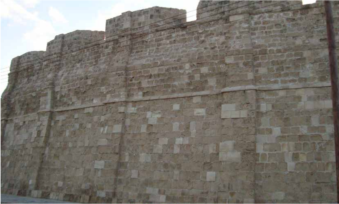
Εικόνα 105: Άποψη του εξωτερικού ανατολικού τείχους του κάστρου της Λάρνακας. Διακρίνονται οι επεμβάσεις αντικατάστασης των κατεστραμμένων λίθων για τις ανάγκες οριζοντίωσης και ενίσχυσης του τείχους. (Προσωπική λήψη 20/3/09).
