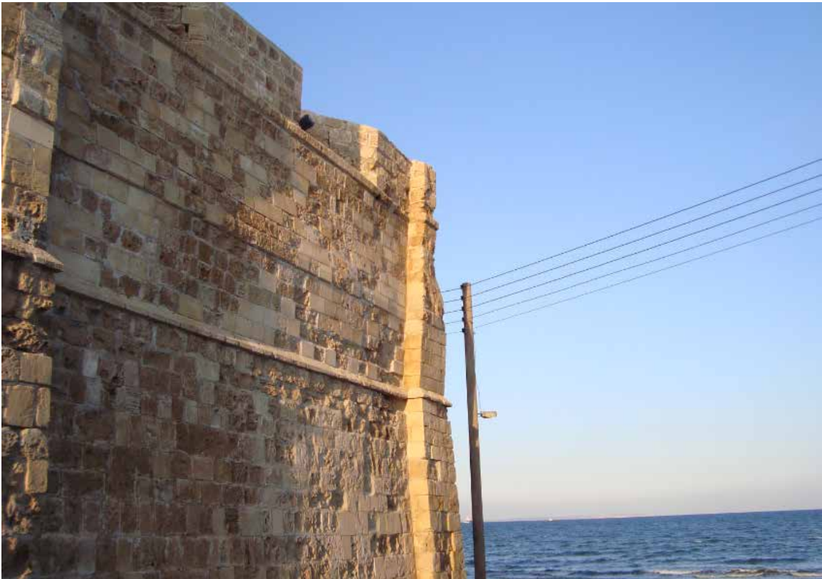
Εικόνα 106: Άποψη του εξωτερικού δυτικού τείχους του κάστρου της Λάρνακας. Διακρίνονται οι επεμβάσεις αντικατάστασης των κατεστραμμένων λίθων για τις ανάγκες οριζοντίωσης και ενίσχυσης του τείχους. (Προσωπική λήψη 20/3/09).
