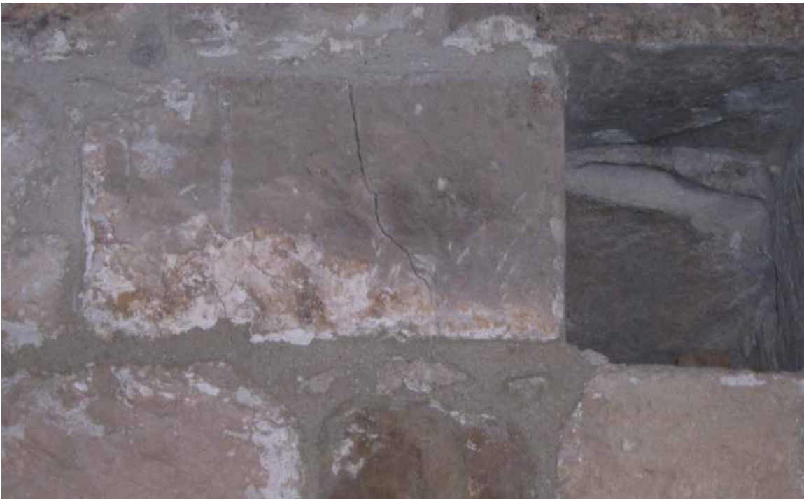
Εικόνα 98: Μικρορογμές σε λίθο στην οροφή του κάστρου του Κολοσσίου που πιθανόν να προέρχεται στην παρουσία μαλακών και σκληρών τμημάτων στο εσωτερικό του λίθου. (Προσωπική λήψη 22/3/09).
