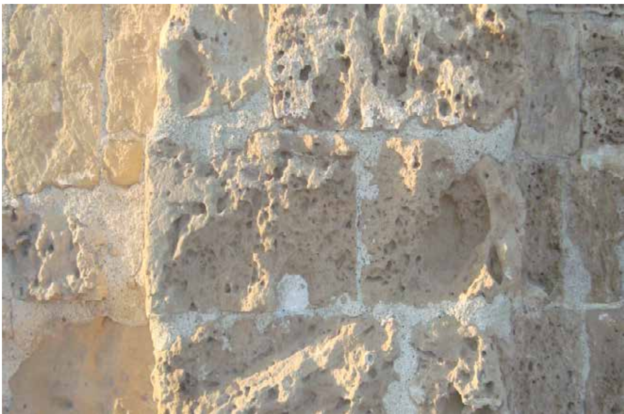
Εικόνα 102: Εμποτισμός με ενέματα σε λίθους στην ανατολική εξωτερική πλευρά του τείχους της Λάρνακας για την ασφαλή στερέωση των ήδη φθαρμένων λίθων του τείχους. (Προσωπική λήψη 20/3/09)
