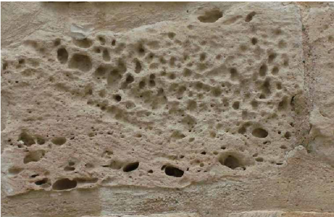
Εικόνα 100: Διάβρωση λίθου στο βόρειο τμήμα του κάστρου της Λεμεσού. (Προσωπική λήψη 19/3/09)
