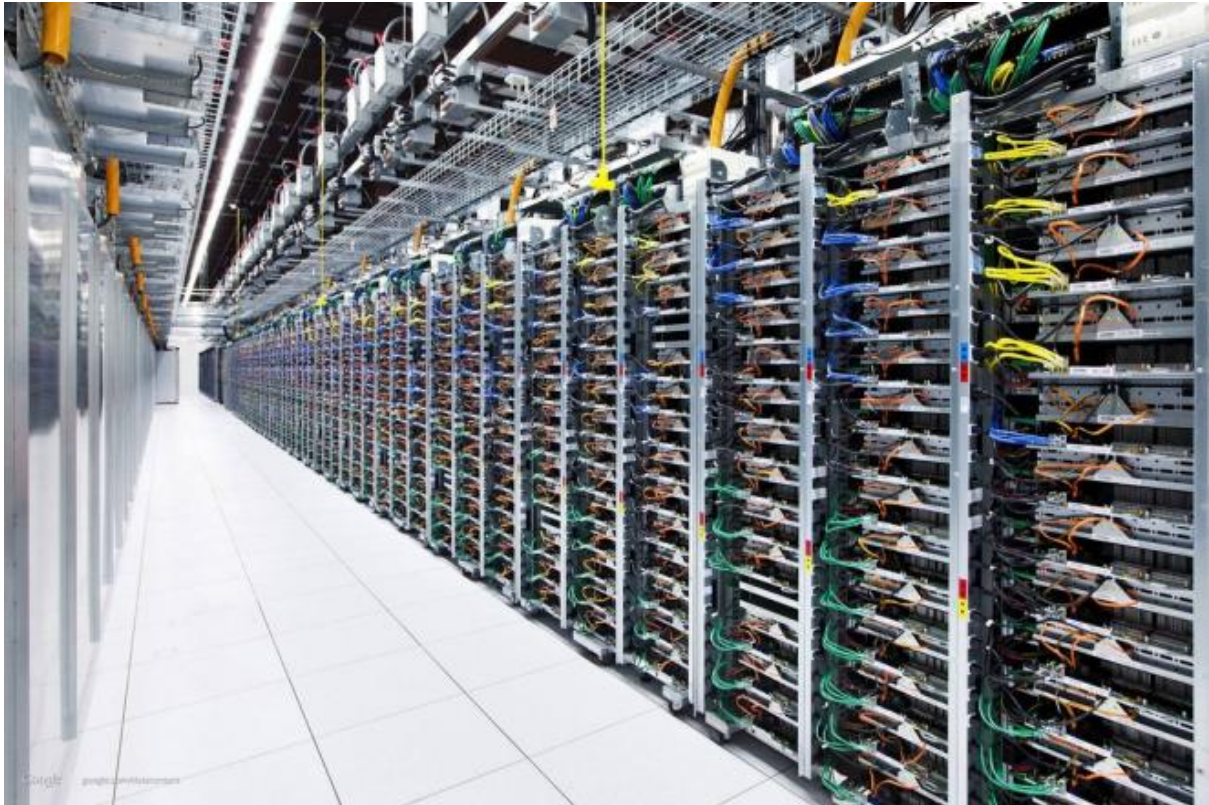
Εικόνα 1: Φωτογραφία από το Data Center της Google
