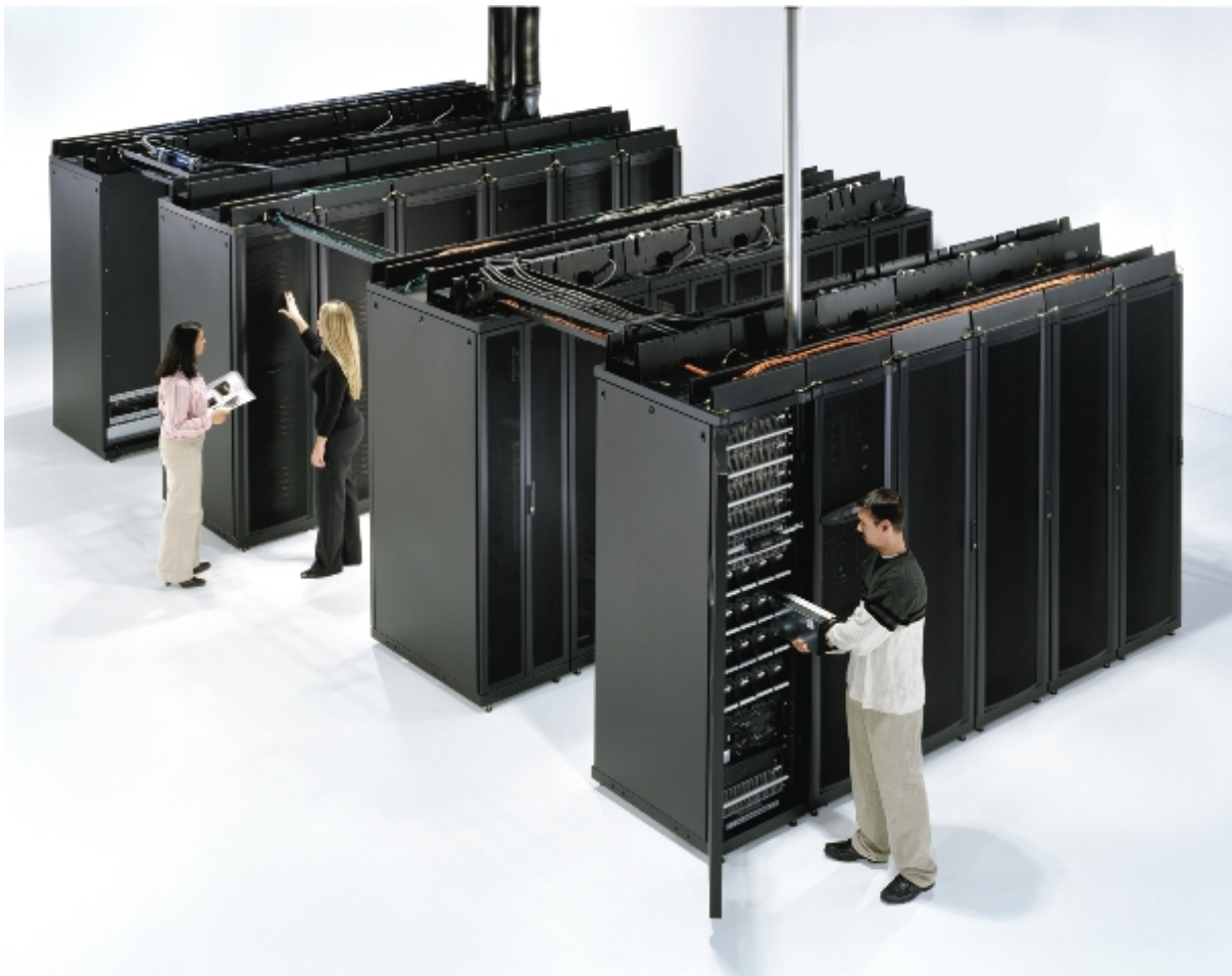
Εικόνα 5: Εργονομική εγκατάσταση ενός Data Center
