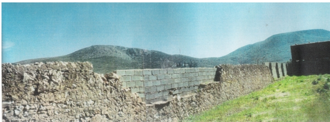
Έντονες φθορές στη λιθοδομική περίφραξη
