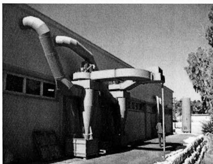
Σχήμα 3.3.γ: Εγκατάσταση πολυκυκλώνων σε ένα εργοστάσιο ξυλείας
