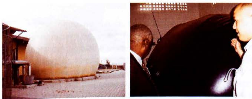
Σχήμα 2.5: Εξωτερικές δεξαμενές αποθήκευσης αερίου χαμηλής πίεσης [25]
