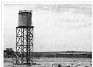
Σύστημα πλήρωσης δεξαμενής
