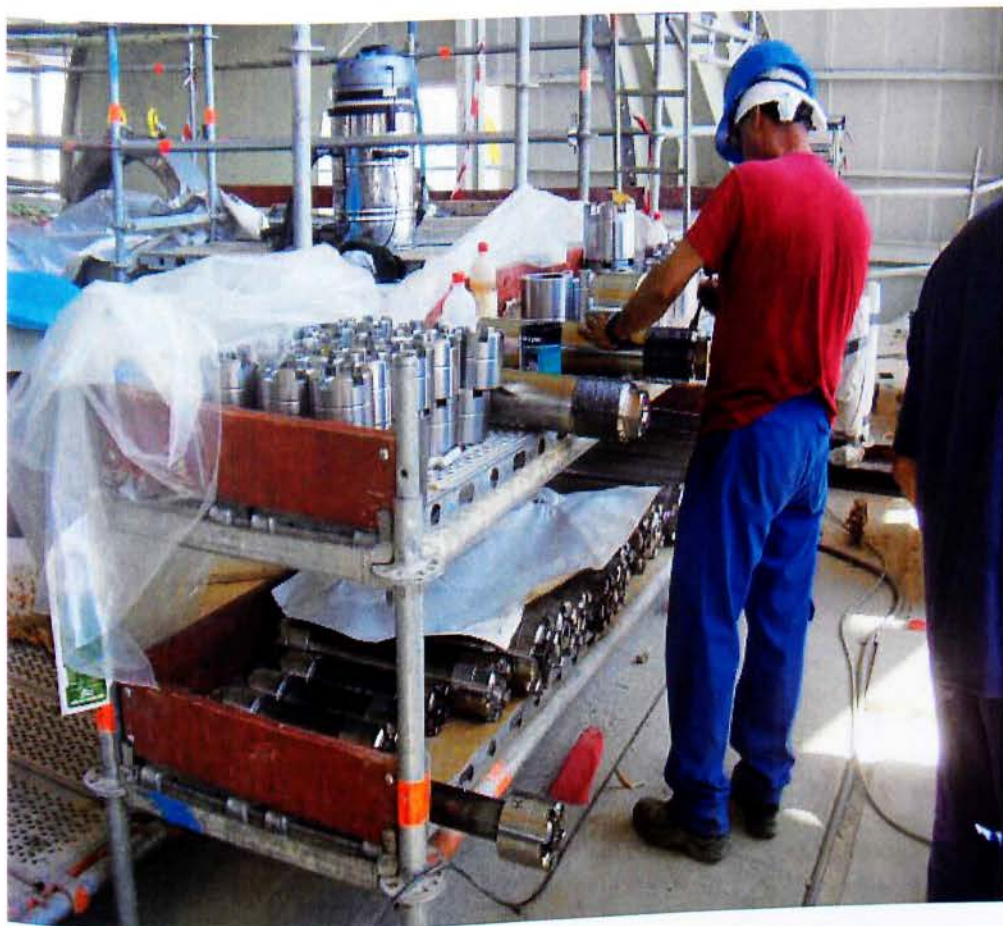
Εικ. 42. Βίδες/ ντίζες οριζόντιων και κάθετων αρμών τουρμπίνας
