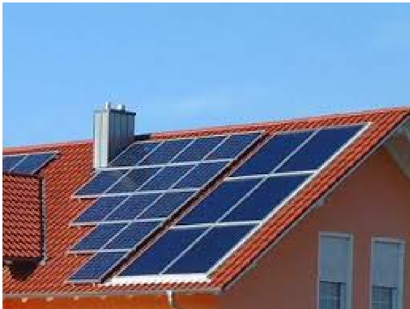
Εικόνα 4.10: Εγκατάσταση Φ/Β σε οικία
