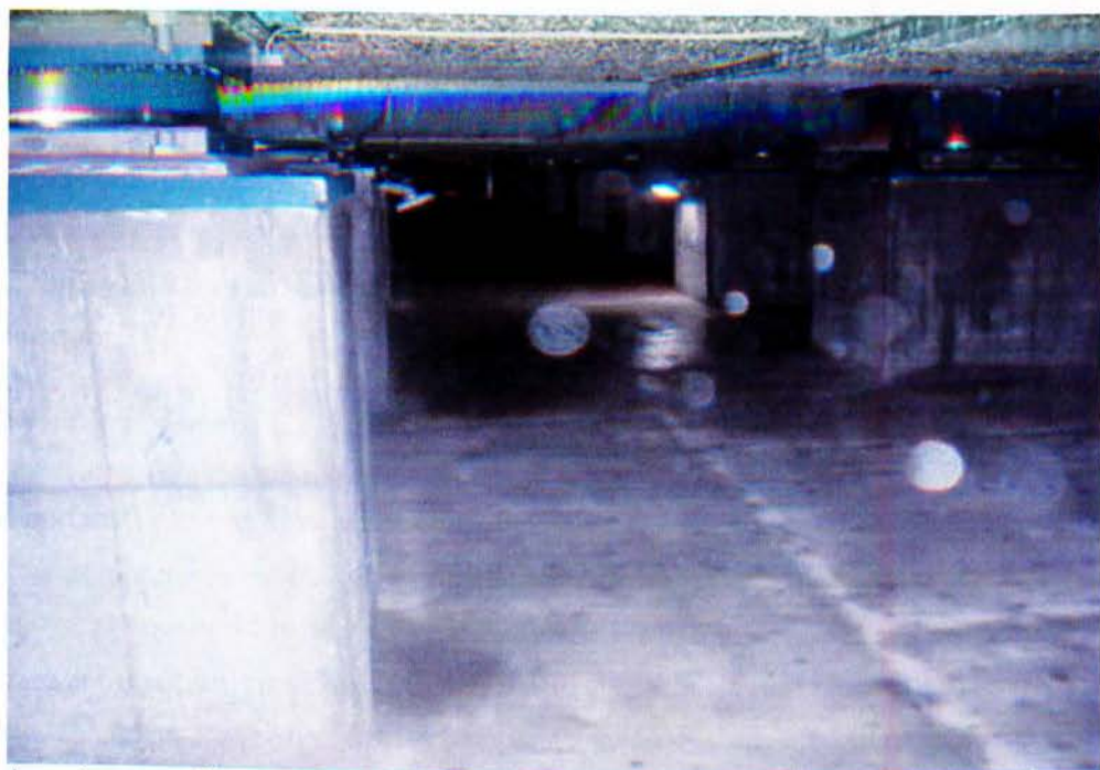
Διακρίνονται οι βάσεις έδρασης της δεξαμενής.
