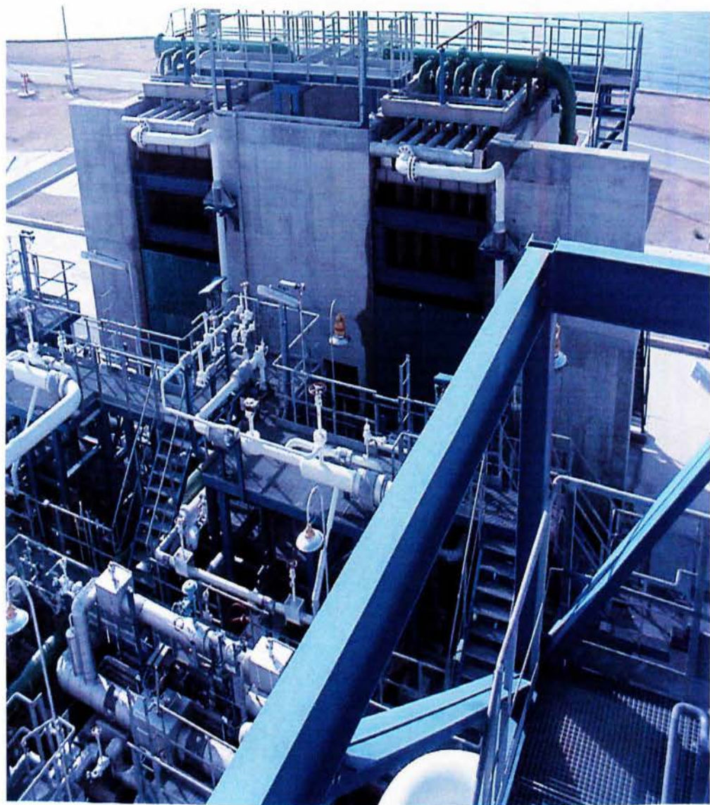
Τρεις αεριοποιητές θαλασσινού νερού, 2 \times 125 \text{m}^3/\text{h} , 1 \times 381 \text{m}^3/\text{h} . (Open Rack Vaporiser, ORV).
