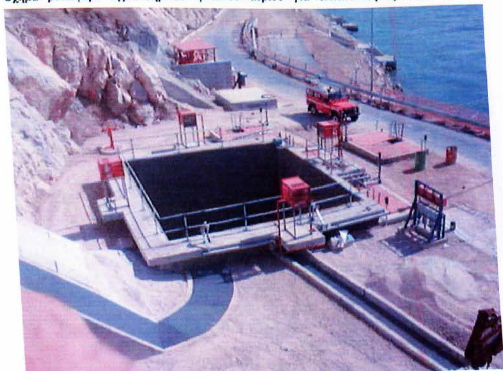
Χώρος περισυλλογής ΥΦΑ, σε περίπτωση διαρροής από τις δεξαμενές.
