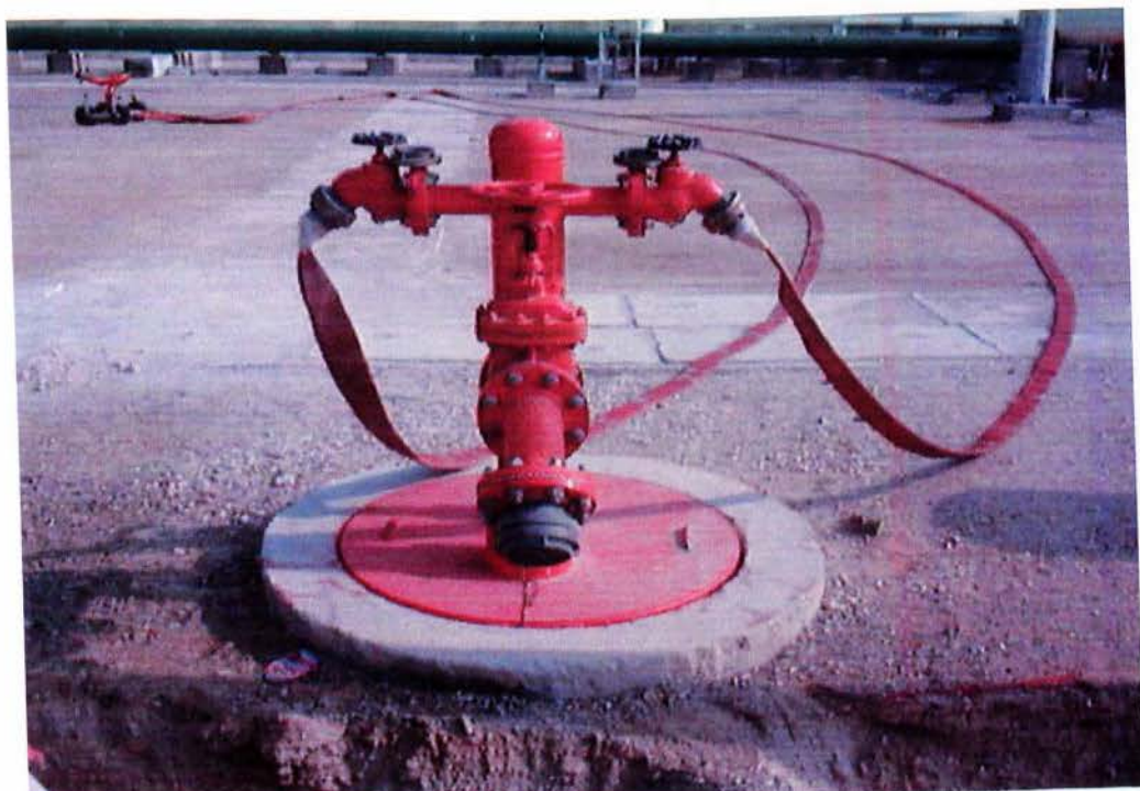
Πυροσβεστικός κρουνός και τροχήλατο μέσο της μάνικας.
