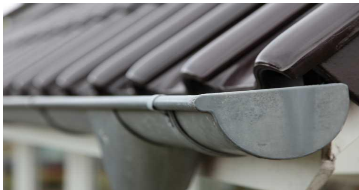
Σχ. 3.2.1.1_1 : Διάταξη ντερέ στο κατώτερο σημείο των κεραμιδιών (4) Διακρίνεται και το κατακόρυφο δίκτυο σωλήνωσης απαγωγής των όμβριων υδάτων προς τις δεξαμενές.
